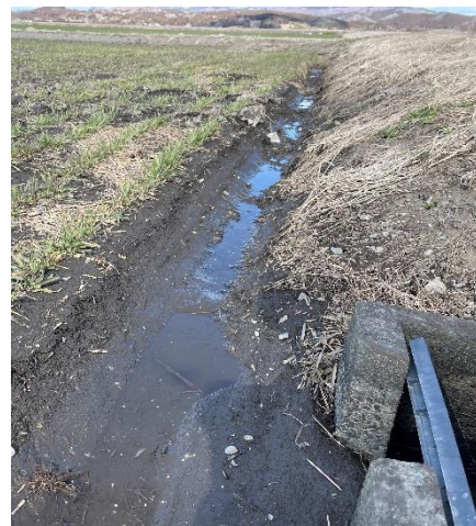
図4 停滞水が溜まる明渠 (落水口前に土が盛り上がっている)
