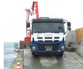
狐崎漁港北防波堤災害復旧工事 「防波堤コンクリート打設状況」
