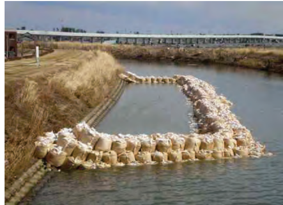
図 3- 86 増田川 仮設沈澱池
