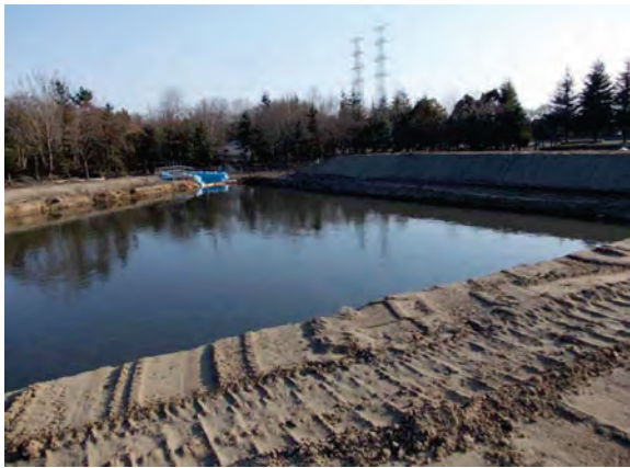
図 3- 83 多賀城緩衝緑地公園内 仮設沈澱池
