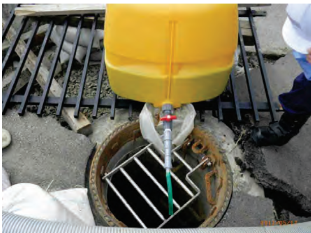
図 3- 87 県南浄化センター 塩素消毒状況
