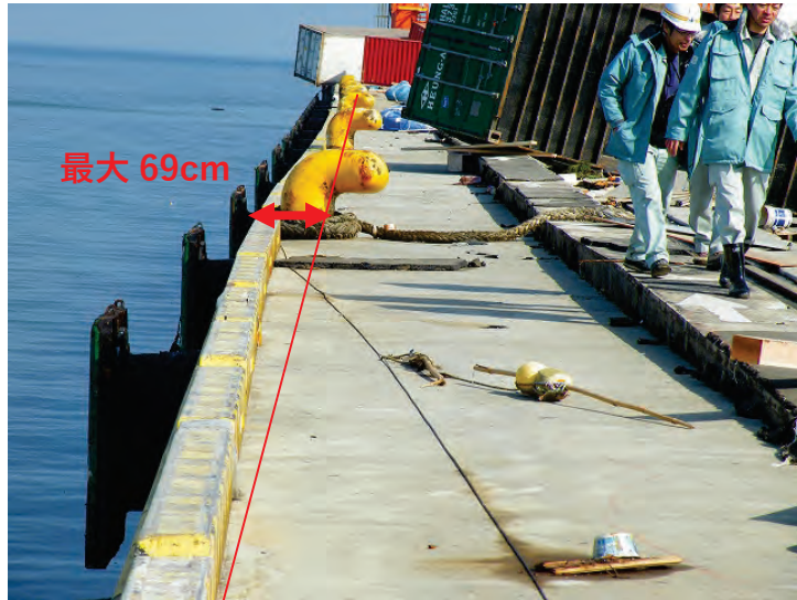
図 3-46 岸壁法線のはらみだし
