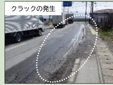
沿岸部の舗装劣化状況
