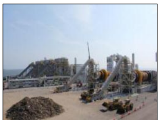
焼却炉稼働時の状況 (石巻ブロック)
