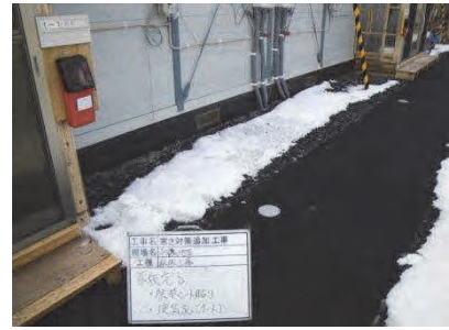
棟間舗装・凍結防止対策
