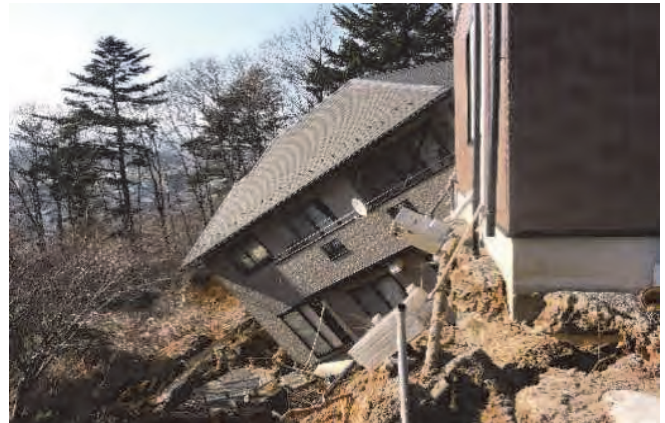
〔写真：宅地の被害により傾いた住宅〕
