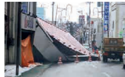
写真:道路を塞ぐ倒壊した家屋(登米市)
