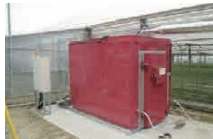
写真:木質バイオマスボイラー
