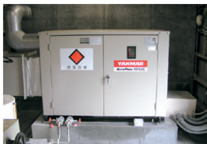
写真:河北警察署非常用発動発電設備
