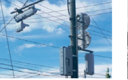
写真:信号機用電源付加装置(リチウム電池式)
