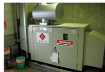
写真：加美警察署 非常用発動発電設備
