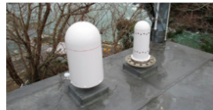
写真:モニタリングステーションに設置している測定器 (左:電離箱 右:Nal)
