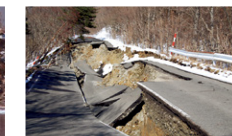
写真:七ヶ宿町(崩落した道路)
