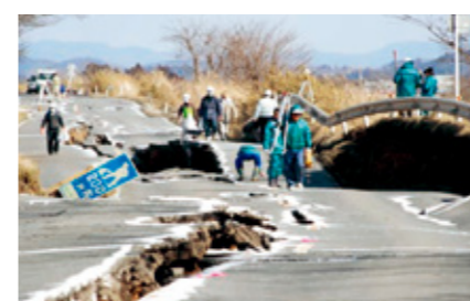
写真:栗原市(大きく波打った道路)
