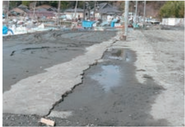
写真 3-21 須賀漁港 (地盤沈下)
