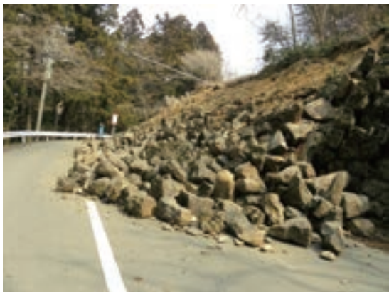
写真 3-13 史跡仙台城跡の石垣の崩落状況
