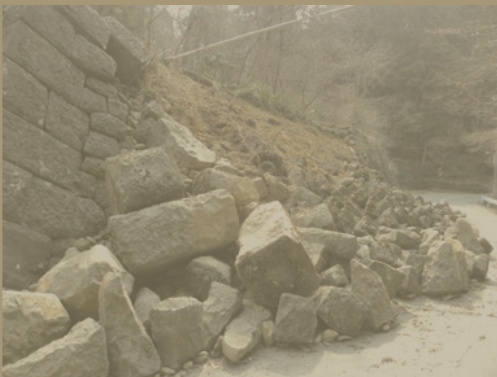
史跡仙台城跡の崩落した石垣
