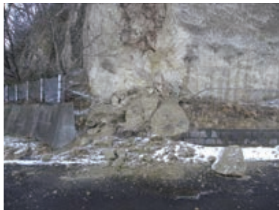
写真 3-14 史跡山畑横穴群の崖の一部が崩落
