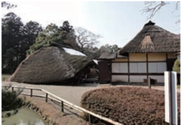
写真 5-9 倒壊した主屋
