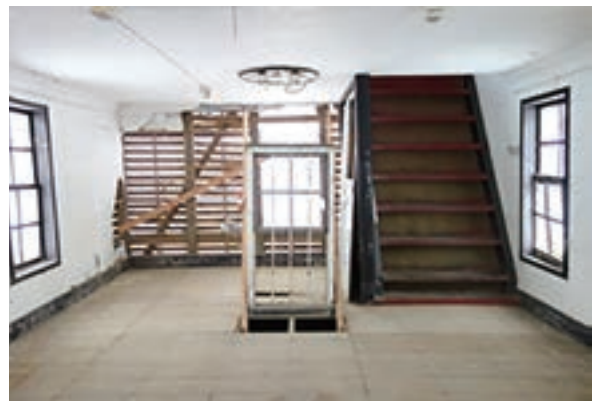
写真 5-14 建物内部の被害状況
