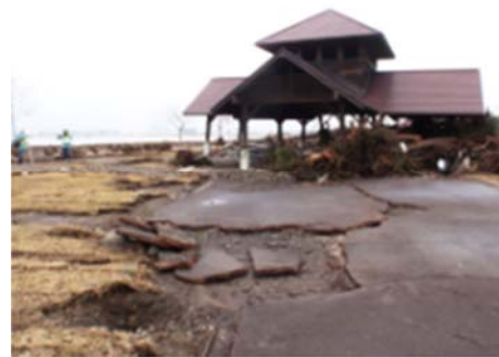
岩沼海浜緑地被災状況
