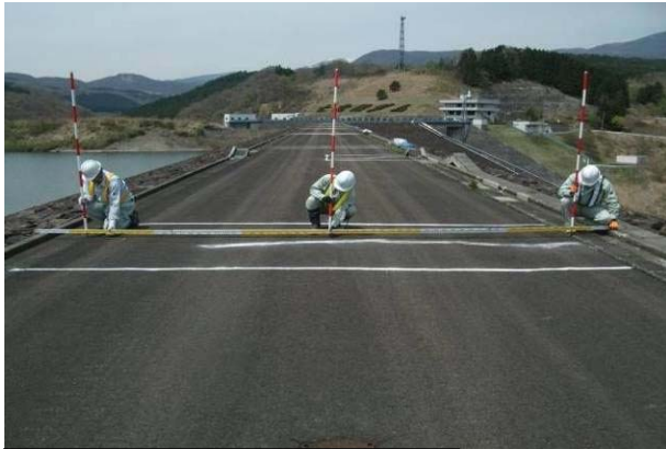
写真-3 七北田ダム被災状況
