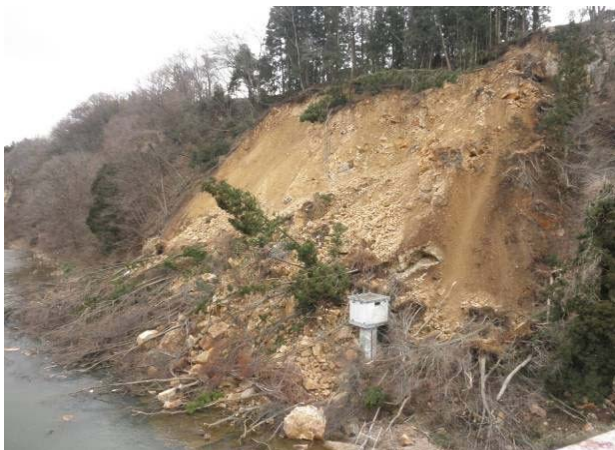
写真-5 白沢水位観測所被災状況
