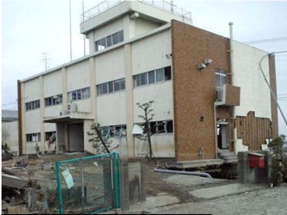
写真-1 事務所の被災状況
