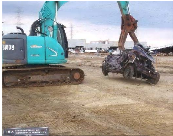
写真-2 被災車両仮置状況 H23.3.28
