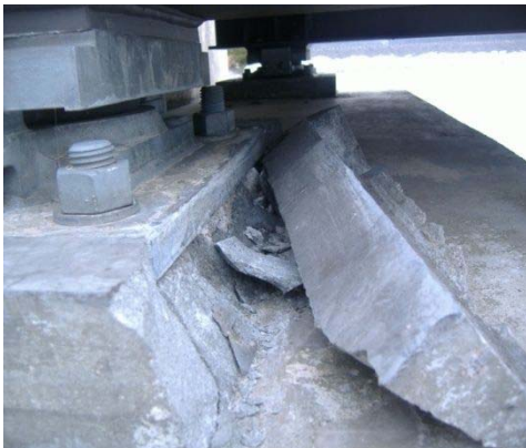
写真-3 小田ダム取水塔管理橋被災状況
