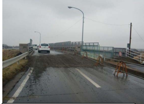
写真-1 (一) 涌谷三本木線化粧坂橋 応急対応の状況
