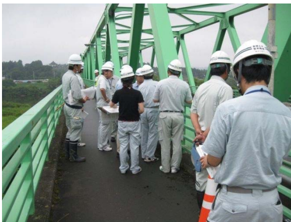
写真-6 錦桜橋の災害査定状況
