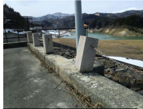
写真-1 荒砥沢ダム防護柵被災状況
