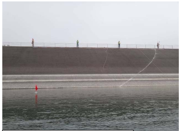
写真-6 南川鞍部ダム被災状況
