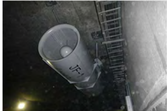
▲平成 25 年 12 月 13 日 本復旧完了 ジェットファン〔φ1000〕
