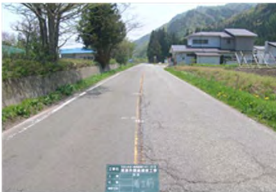
▲(国)113線 七ヶ宿町滑津地内 路面損傷状況
