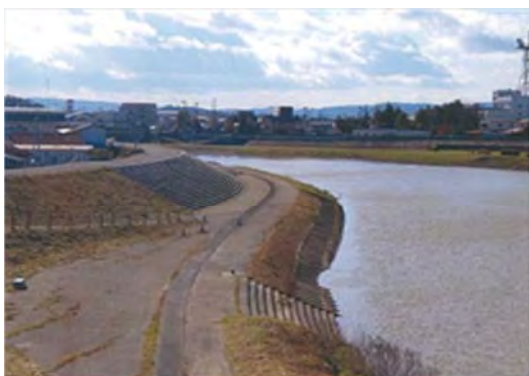
▲迫川左岸 登米市迫町佐沼地内 低水護岸被災状況
