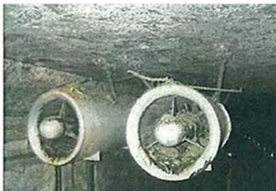
▲仙台空港トンネル 岩沼市下野郷地内 ジェットファン〔φ600〕被災状況
