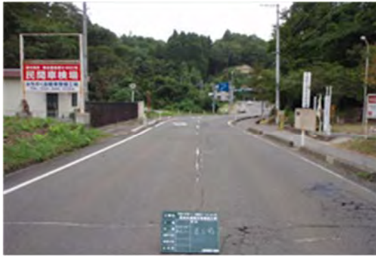
▲(一)西成田宮床線 大和宮床地内 路面被災状況
