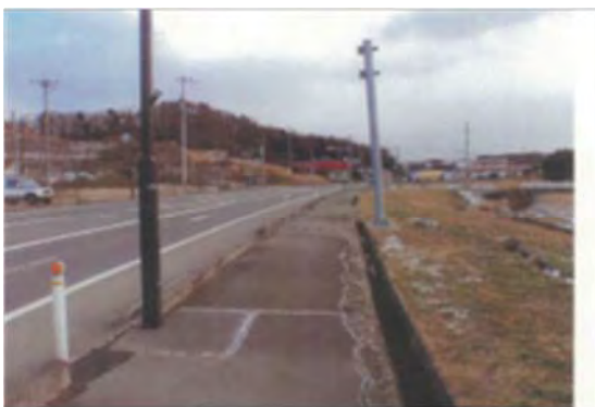
▲(主)大和松島(線) 黒川郡大郷町土橋地内外 路面被災状況
