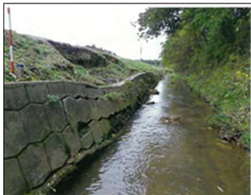
▲一級河川 田尻川 大崎市古川中雨生沢地内 堤防法面崩壊状況
