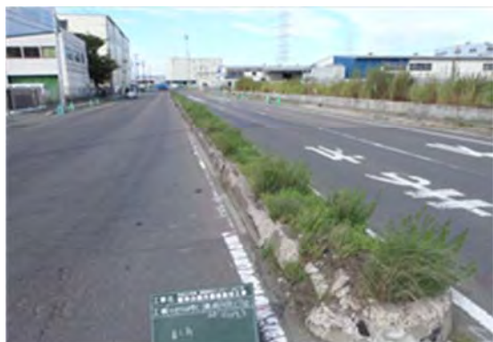
▲臨港道路ふ頭 2 号線 仙台市地内 路面クラック状況
