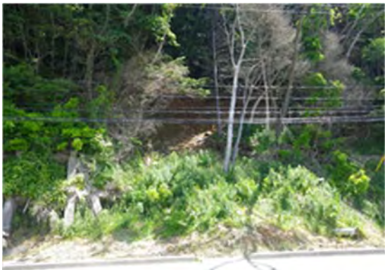
▲平成 24 年 7 月 7 日着工 大浜外道路災害復旧工事 法面崩壊状況
