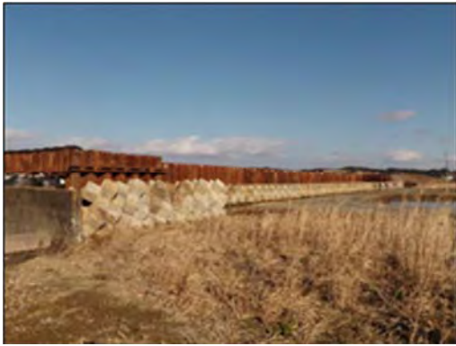
▲一級河川 出来川 涌谷町新名鱒地内 堤防（川裏）決壊状況
