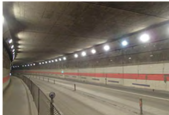
▲平成 25 年 12 月 13 日 本復旧完了 トンネル照明〔セラミックメタルハライド灯〕
