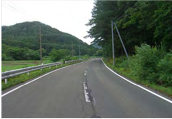
▲国道113号 七ヶ宿町湯ノ原地内 路面損傷状況
