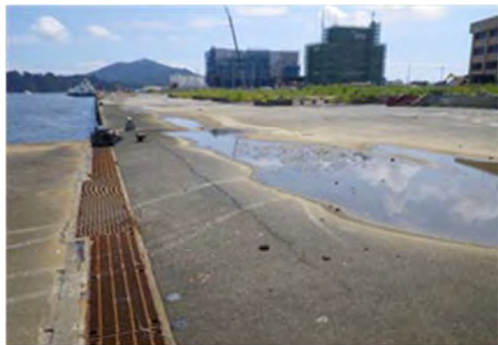
▲気仙沼港 朝日地区 気仙沼市朝日地内 -4.5m 岸壁 沈下状況
