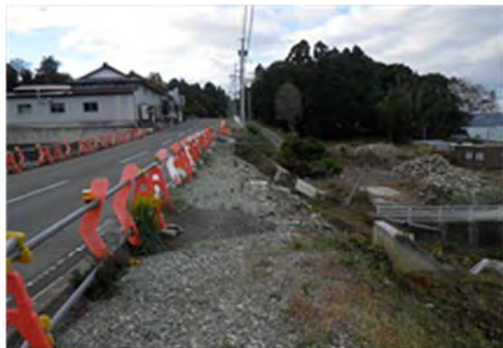
▲ (国) 398号 南三陸町戸倉字津の宮地内 歩道被災状況
