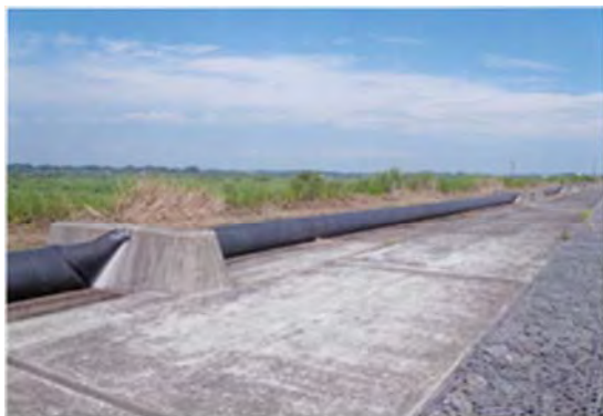
▲野谷地越流堤 登米市南方町新野谷地地内 越流堤沈下状況
