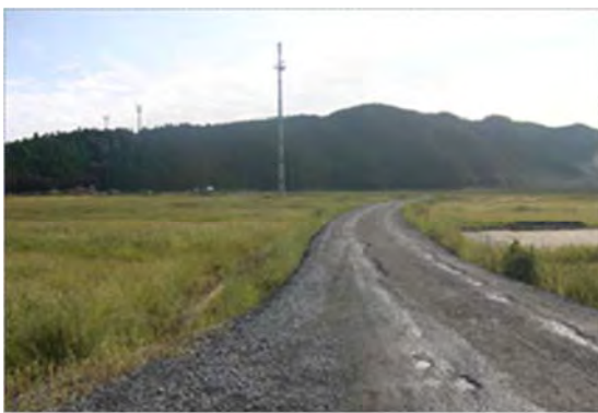
▲平成 24 年 9 月 12 日 釜谷道路災害復旧工事 路面被災状況
