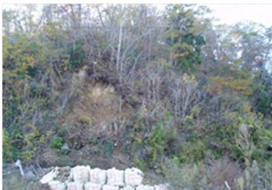
▲(一) 清水浜志津川港線 南三陸町志津川字清水地内 道路法面被災状況
