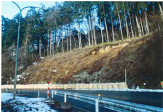
▲(国) 2 8 6 号 川崎町支倉字中原裏山地内 道路路面崩壊状況 24 災 16 号
