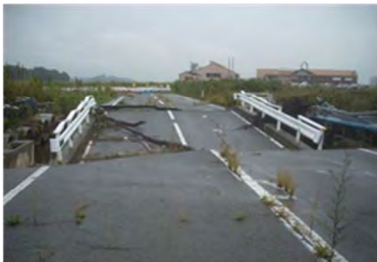
▲（主）相馬亙理線(高浦橋) 山元町中浜地内 被災状況
