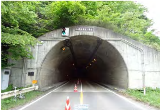
▲国道113号 白石市小原地内 トンネル照明設備更新前
