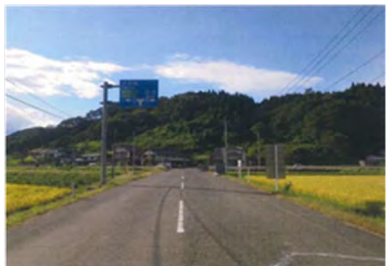
▲(一)名取村田線 村田町菅生字寺下地内 311 地震災 222 号 路面被災状況
