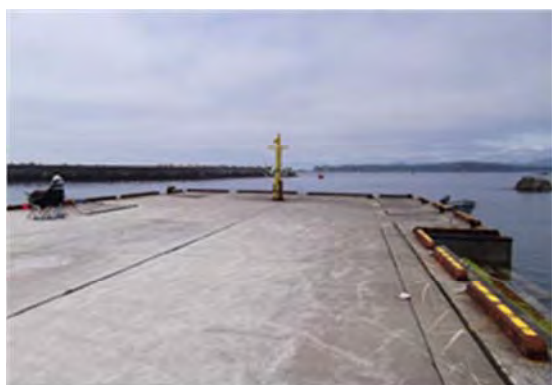
▲御崎港 気仙沼市唐桑町崎浜地内 -2.0m 物揚場 沈下状況
