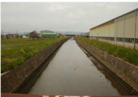
▲川内沢川 名取市地内 被災状況
