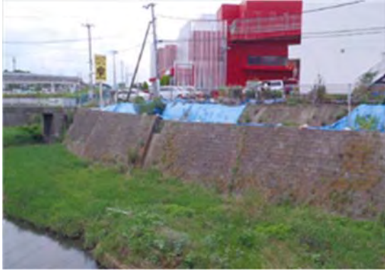
▲要害川 仙台市泉区七北田地内 被災状況
