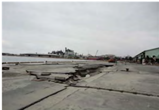
▲大手岸壁・荷捌地被災状況 平成 23 年 3 月 15 日
