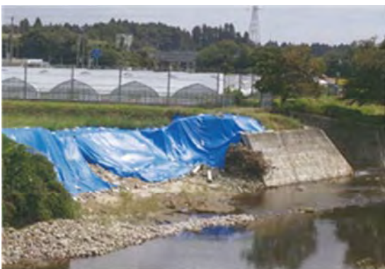
▲七北田川 仙台市泉区野村地内被災状況
