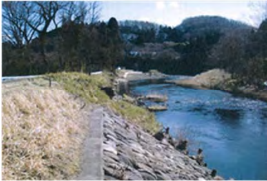
▲七北田川 仙台市泉区野村地内 被災状況
