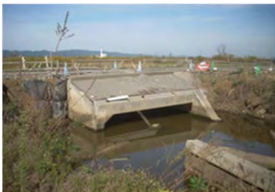
▲（主）相馬亙理線(笠浜橋) 山元町高瀬地内 被災状況
