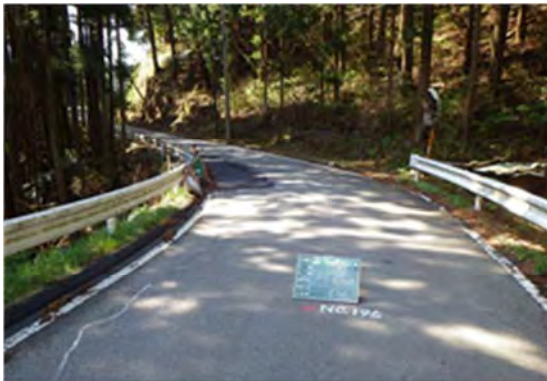
▲平成 24 年 7 月 18 日 着工 船越（1）外道路災害復旧工事 路面被災状況
