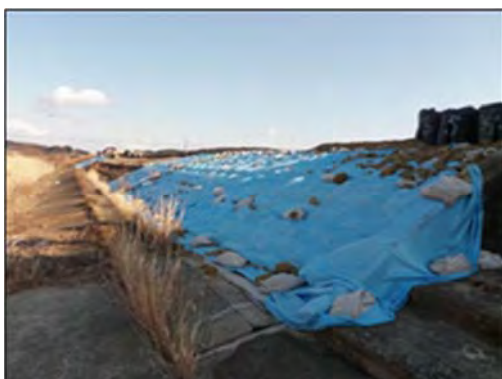
▲一級河川 出来川 涌谷町新名鱈地内 堤防（川表）決壊状況
