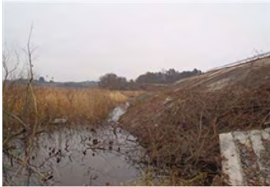
長沼川 登米市迫町北方字羽河地内 ブロック張被災状況
