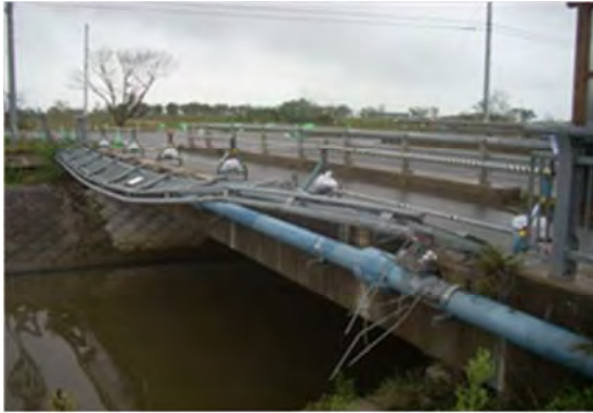
▲(主)相馬亙理線(耕不切橋) 山元町山寺地内 被災状況
