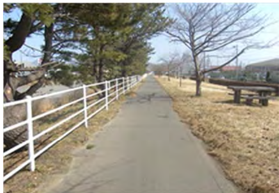
▲北上運河 石巻市蛇田地内外 運河沈下状況
