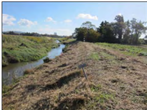
▲一級河川 田尻川 大崎市田尻中目地内 堤防法面崩壊状況
