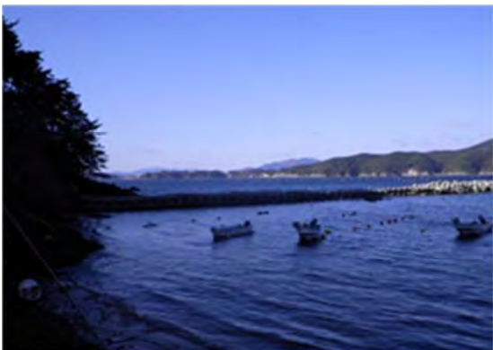
▲唐桑海岸 栢浜地区海岸 突堤(2) 沈下状況
