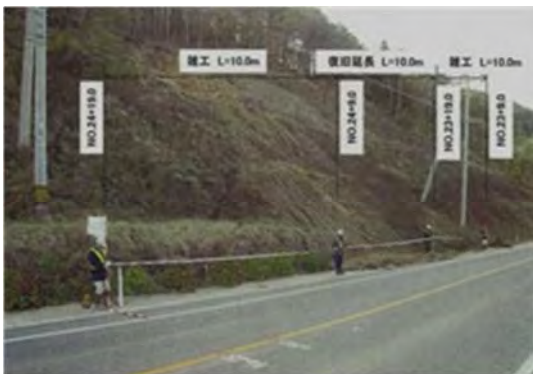
▲(主) 石巻鮎川線 石巻市渡波地内 法面崩壊状況
