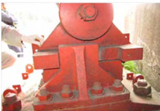
▲(主) 亙理大河原川崎線 角田市大字江尻地内 移動制限装置の異常遊間状況
