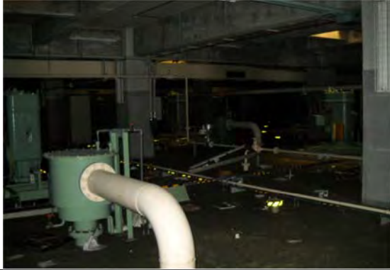
▲平成 23 年 3 月 17 日被災状況 石巻東部浄化センター 2 系水処理施設反応タンク
