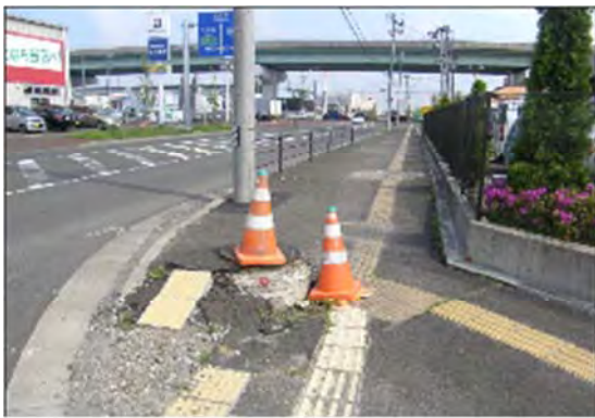
▲地震により隆起したマンホール
