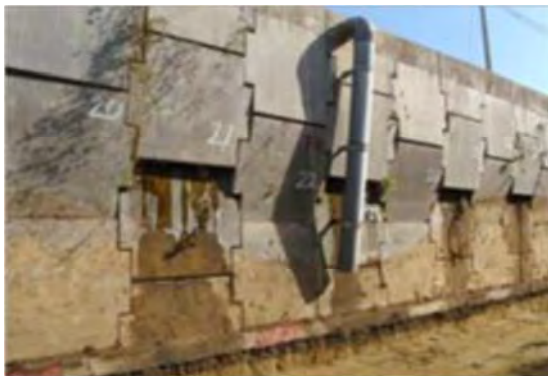
▲(一)大衡仙台線 大和町小野地内 補強土壁被災状況
