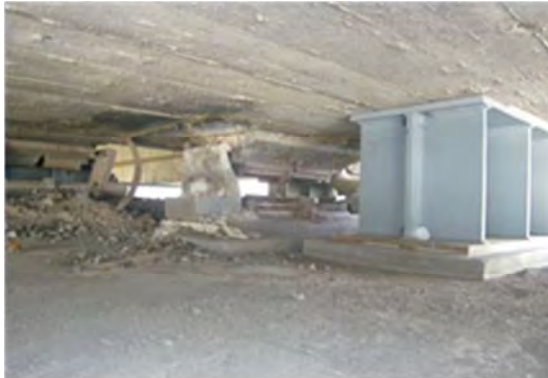
▲（主）塩釜亙理線(関上大橋) 名取市関上地内 支承被災状況
