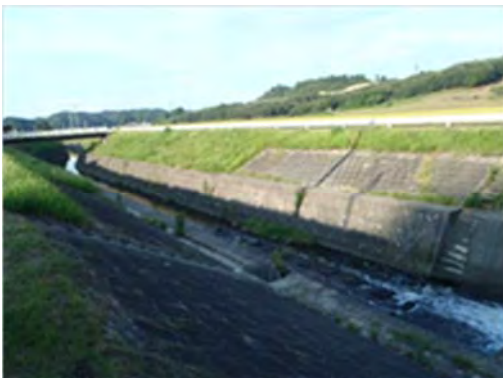
▲明石川 富谷町西成田地内 被災状況
