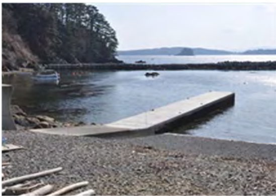
▲唐桑海岸 栢浜地区海岸 突堤(1) 沈下状況
