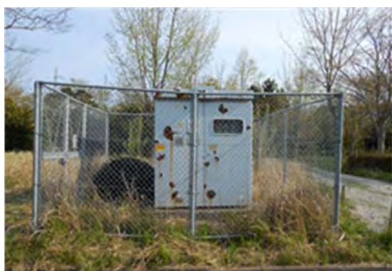
▲仙台港多賀城地区緩衝緑地 多賀城市大代地内 配電盤被災状況
