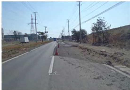
▲臨港道路蒲生幹線 仙台市地内 路面クラック状況
