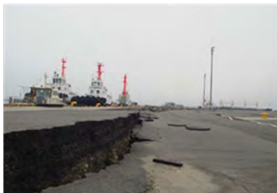
▲雲雀野北埠頭岸壁・荷捌地被災状況 平成 23 年 3 月 15 日
