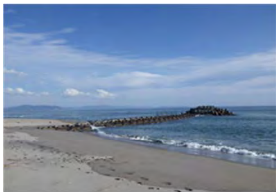
▲大曲海岸 東松島市大曲地内 4号突堤沈下状況
