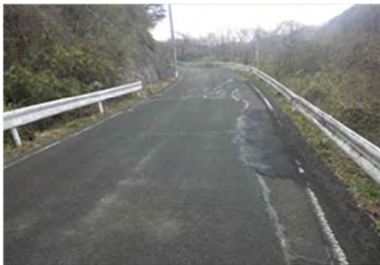
▲(一)名取村田線 名取市高館川上地内 路面被災状況
