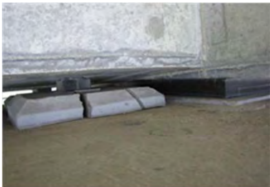
▲(主) 亙理村田線 柴田町下町地内 橋梁沓座モルタル破損状況
