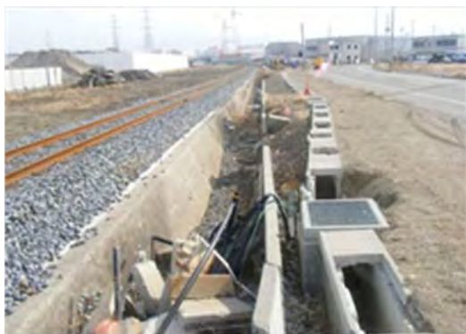
▲津波により倒壊した道路施設 (港北工業幹線)
