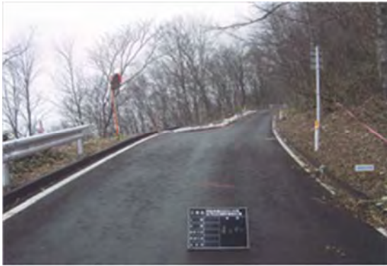
▲(一)青根蔵王線 川崎町前川字沼ノ平山地内 道路路面崩壊状況 23 災 311 号
