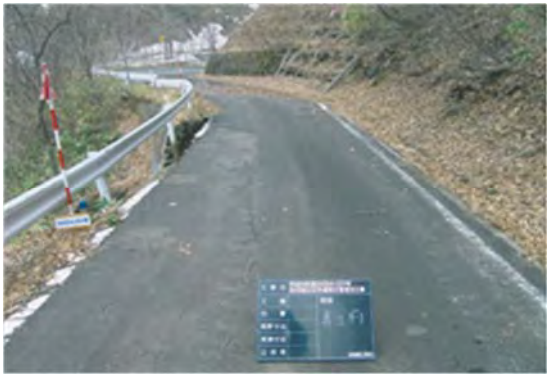
▲(一)青根蔵王線 川崎町前川字手代塚山地内 道路路面崩壊状況 24 災 4 号
