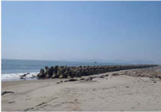
▲浜市海岸 東松島市浜市地内 消波堤沈下状況
