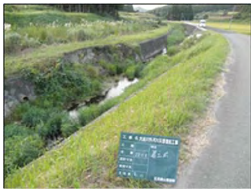
▲二級河川 大迫川 大崎市鹿島台大迫地内 堤防法面崩壊状況
