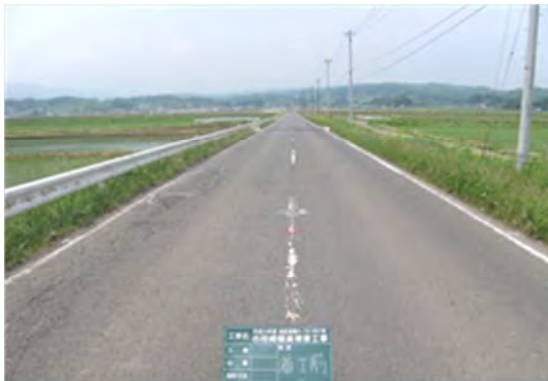
▲(主)岩沼蔵王線 蔵王町小村崎地内 路面損傷状況
