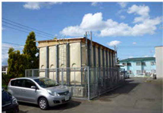
▲古川工業高 大崎市古川北町地内 受水槽〔FRP 製〕被災状況（仮復旧後）
