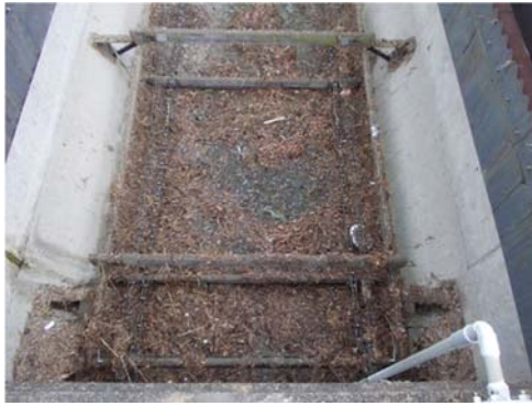
▲「終沈」被災直後 ガレキ・土砂流入状況
