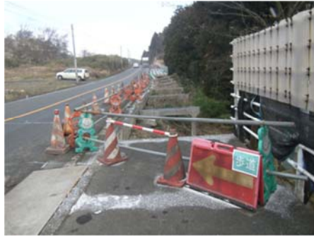
▲(主)古川佐沼線 迫町北方 被災状況
