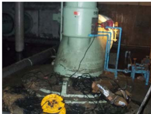
▲5号汚水ポンプ被災後
