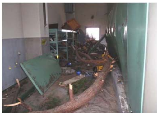
▲機械濃縮設備被災後
