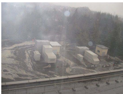
▲自家用発電機
