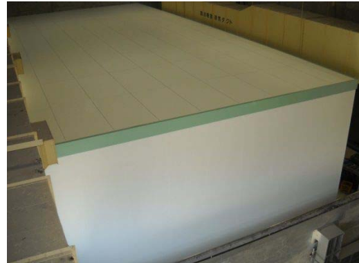
▲新電気室施工後
