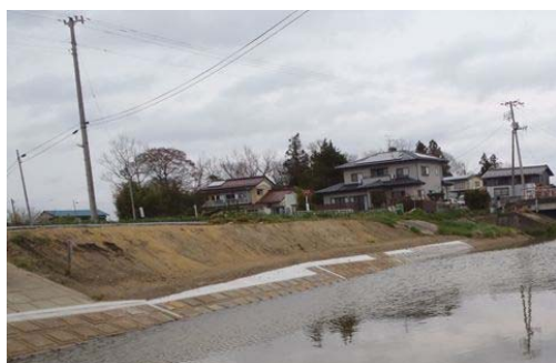
▲尾袋川（角田市佐倉①）復旧後
