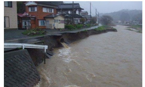
▲鹿折川 被災状況
