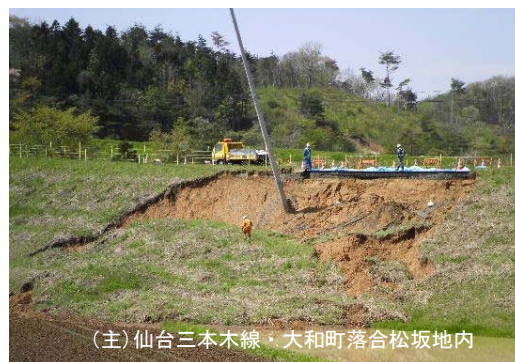
▲道路被災状況
