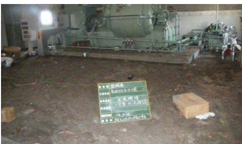
▲送風機設備被災後 ガレキ・土砂堆積状況
