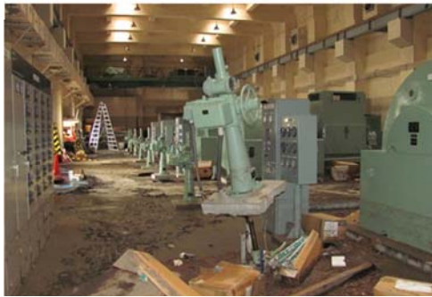
▲「送風機設備」被災直後 ガレキ・土砂流入状況
