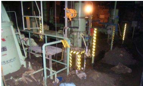
▲ポンプ設備被災後 ガレキ・土砂堆積状況
