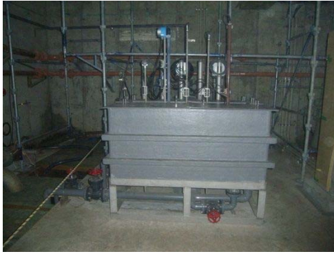
▲流入水質測定装置設置状況
