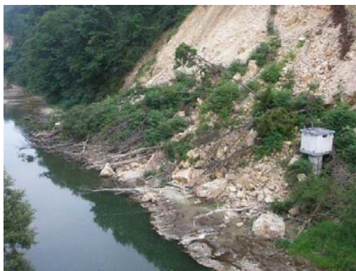
▲白沢河川水位観測所 復旧前 崖の崩落により観測所の機能停止
