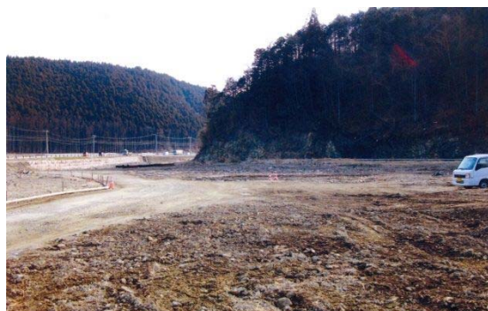
▲西戸橋復旧前
