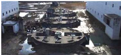
▲重力濃縮槽被災後
