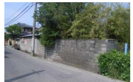
▲危険ブロック塀の例(ひび割れ)
