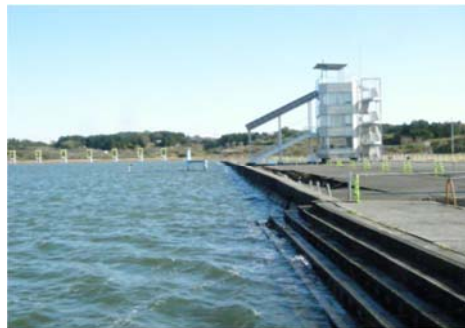
▲長沼ダム 護岸 被災状況
