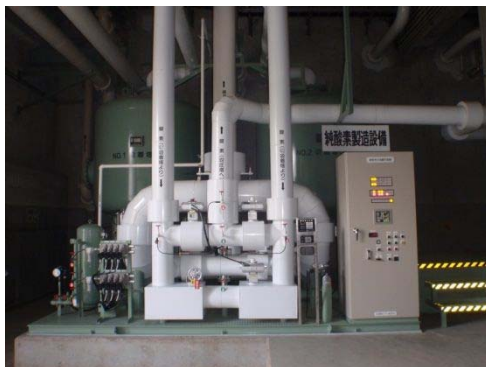
▲純酸素発生装置試運転調整完了
