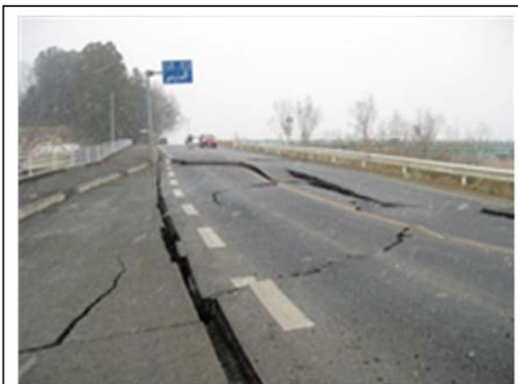
▲国道 346 号 登米市米山町櫓場地内 路面亀裂発生状況
