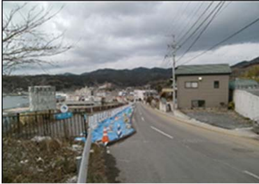
▲(一)牡鹿半島公園線 石巻市鮎川浜地内 路面被災状況
