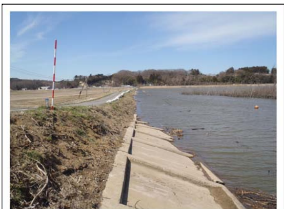
▲(一)荒川 栗原市築館町字横須賀地内 堤防沈下状況
