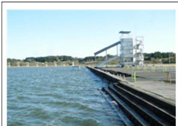
▲長沼ダム 登米市迫町北方地内 護岸被災状況
