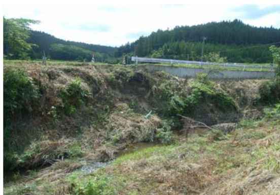
一級河川小山田川 大崎市岩出山葛岡地内 法綿崩壊状況
