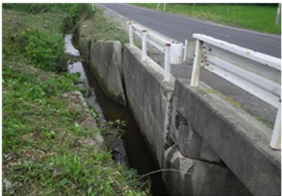
▲ (主) 栗駒岩出山線大崎市岩出山九十田地内 路面被災状況
