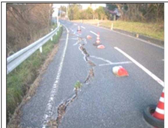
▲ (一) 大島線 気仙沼市中山地内 路面ひび割れ状況
