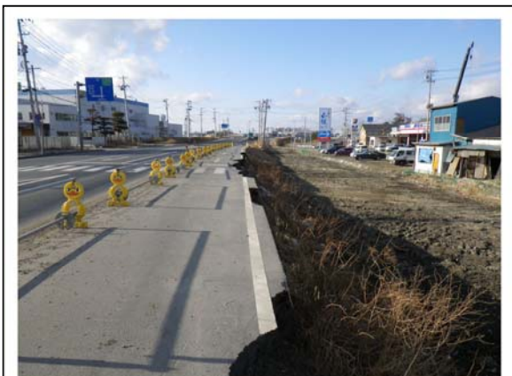
臨港道路釜北線石巻市重吉町地内 道路法面崩壊状況
