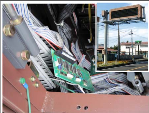
▲ (主) 築館栗駒公園線 栗原市築館地内 宮野道路情報表示板損傷 (基盤脱落) 状況
