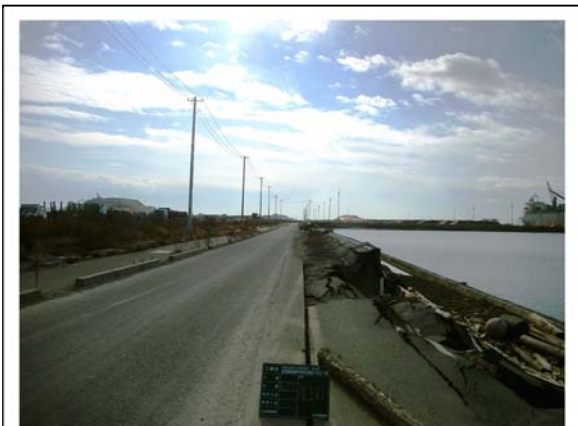
臨港道路雲雀野中央線石巻市雲雀野町地内 道路法面崩壊状況
