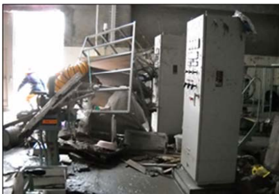
石巻東部浄化センター 中央管理棟内（モーター室） 汚水ポンプ設備被災状況（土砂・瓦礫の流入）
