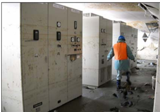
石巻東部浄化センター 脱水機棟1階 電気室被災状況（土砂・瓦礫の流入）
