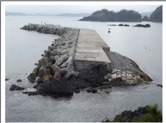
御崎港 防波堤 被災状況（沈下）
