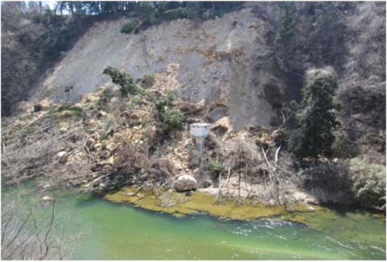
名取川水系広瀬川右岸筋 白沢河川水位観測所 法面崩壊状況
