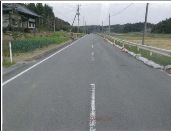
▲ (一) 大鳥沢辺線 栗原市栗駒栗原地内 路面被災状況
