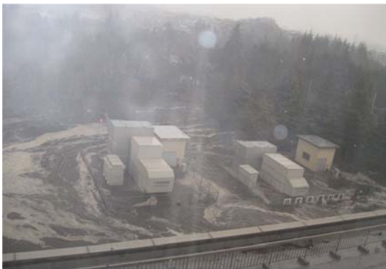
仙塩浄化センター 非常用自家発電設備
