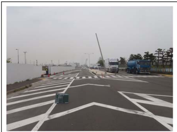
▲仙台港区ふ頭5号線津波被災状況
