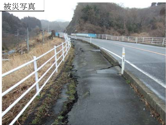
▲(国)346号 松島町根廻地内 道路路肩沈下・損壊・亀裂状況
