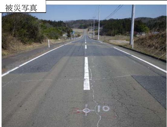
▲(主)仙台三本木線 大和町落合松坂地内 道路亀裂状況
