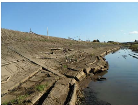
▲ (一) 旧迫川 登米市米山町中津山地区内 護岸被災状況
