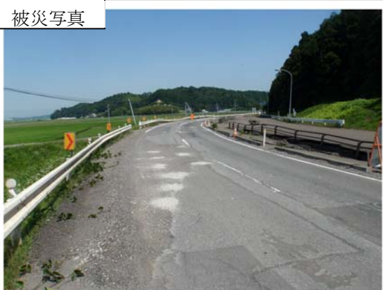
▲(一)大和幡谷線 大郷町不来内地内 路面沈下・亀裂被災状況
