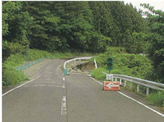
(主)白石国見線 白石市小原字八本樽 道路崩壊状況
