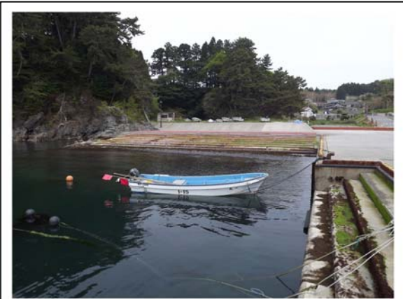
御崎港 船揚場 被災状況（沈下）
