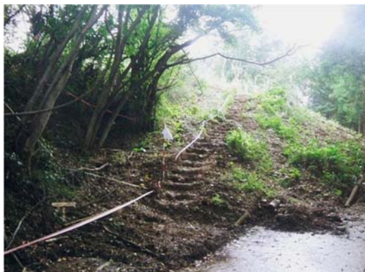
▲ (一) 名取村田線村田町長谷小屋地内 法面崩壊状況
