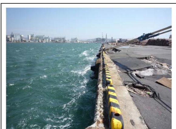
南浜岸壁 沈下状況
