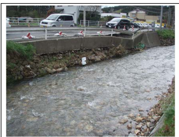
▲国道346号 気仙沼市猪ノ鼻地内 道路崩落状況
