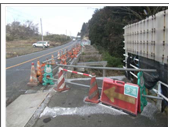
▲（主）古川佐沼線 登米市迫町北方地内 組立歩道被災状況
