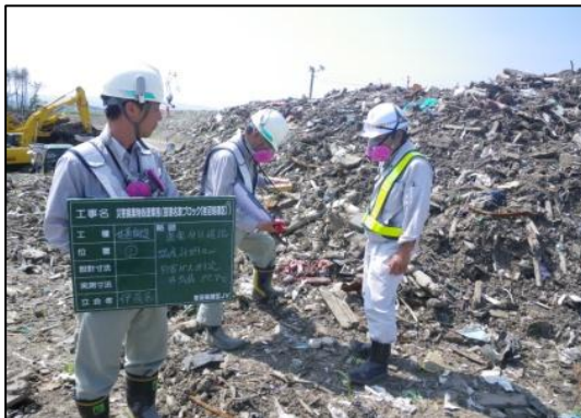
写真7-28 可燃混合物温度測定状況
