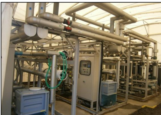
写真7-30 脱塩プラント全景
