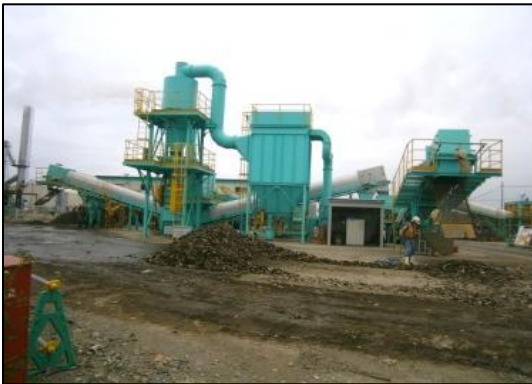
写真7-12 風力選別施設
