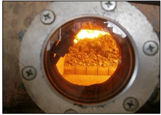
写真7-18 焼却状況（固定床式ストーカ炉）
