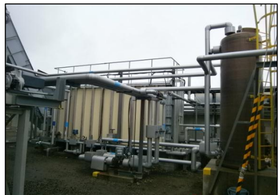
写真7-31 脱塩プラント貯留タンク
