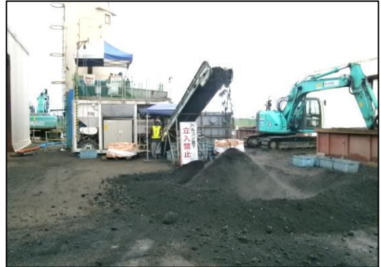
写真7-33 主灰造粒固化状況
