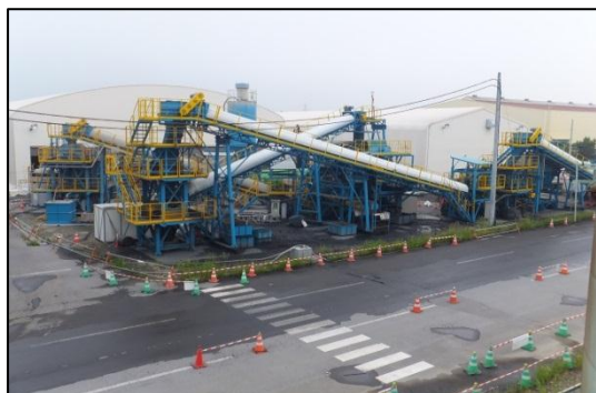
写真5-25 主灰造粒固化施設
