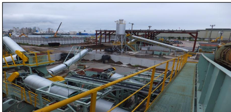
写真5-21 津波堆積物処理設備全景（湿式）
