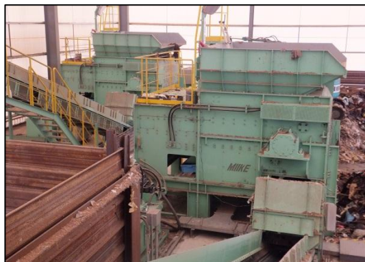
写真5-17 粗大物破碎機2基
