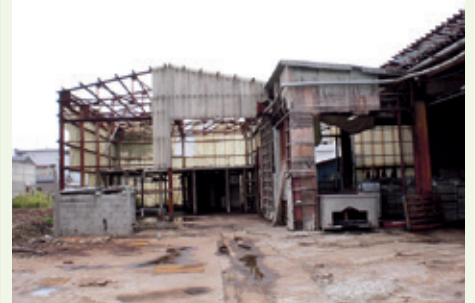
写真:震災後の水産加工工場(塩竈市)
