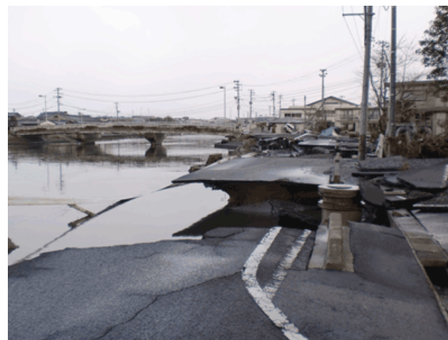
事務所進入路被災状況
