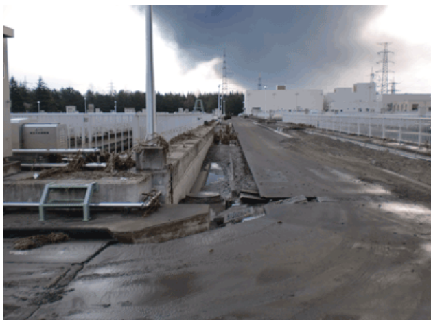
場内被災状況
