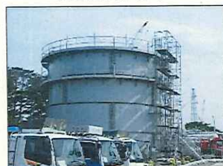
処理水バッファタンク
