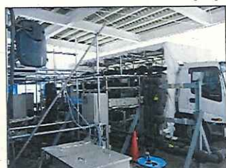
高台炉注水ポンプ
