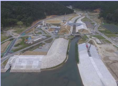
①大原川河川災害復旧工事 ②石巻市雄勝地内 ③護岸工事を施工中 ④67%
