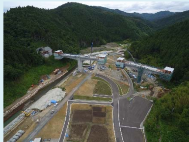
①国道398号相川復興道路事業 ②石巻市北上町十三浜 ③道路改良工事及び橋梁工事を施工中 ④77%
