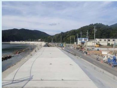
①大原地区海岸災害復旧工事 ②石巻市 大原浜地先 ③天端被覆工事を施工中 ④97%
