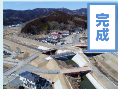
①中島川外河川災害復旧工事 ②石巻市中島字石湊地内外 ③H31.3完成 ④100%
