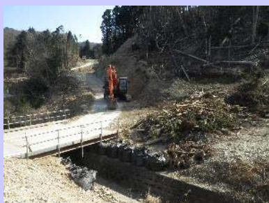
①飯子浜復興道路工事 ②女川町飯子浜地内 ③橋梁下部工事施工のための工事用道路を施工中 ④44%
