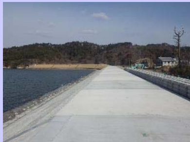
①長石地先海岸災害復旧工事 ②東松島 市大塚地内 ③圧密沈下促進中 ④76%
