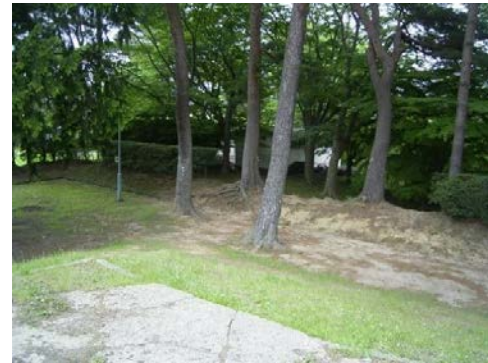
樹木根の影響（多賀城廃寺跡）
