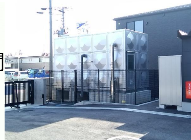
衛生設備（設計・工事）
