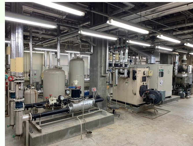
空気調和設備（設計・工事）
