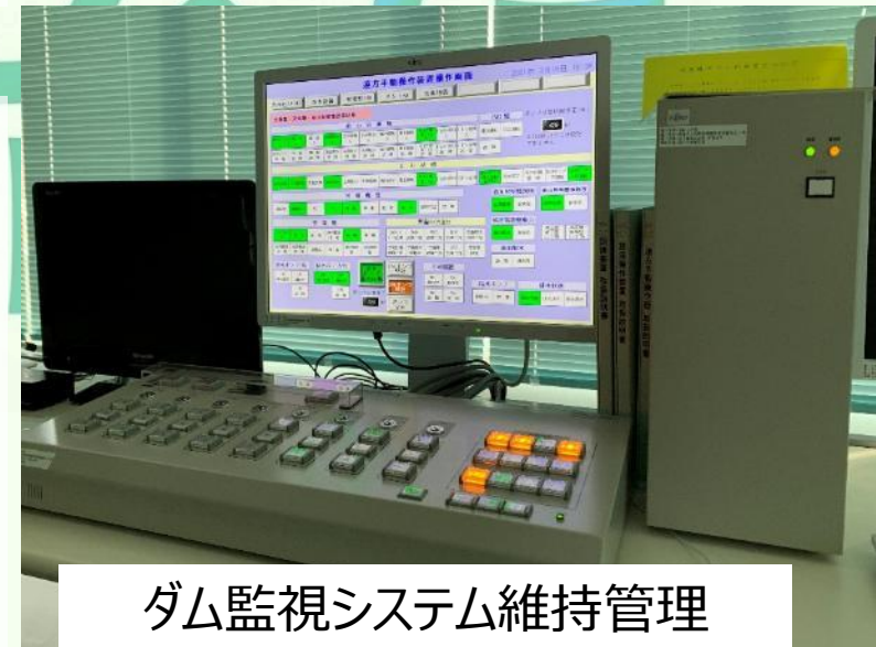
電気設備点検立会
