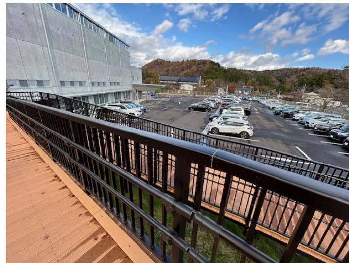
【高台グラウンドから流れた水により 浸水した校舎1階及び駐車場】
