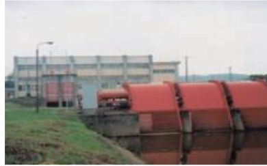
南方揚水機場
