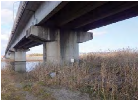
⑩ (主) 塩釜亙理線 名取市閑上地内 社会資本整備総合交付金(復興枠) 閑上大橋耐震補強
