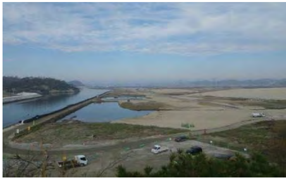
③ 東名地先海岸 東松島市大塚地内 海岸堤防復旧工事
