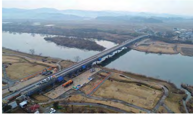
豊里大橋橋梁耐震補強外工事 既設床版撤去施工中（平成31年3月）
