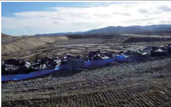
⑤ 長塩谷 石巻市十三浜長塩谷地内 海岸堤防復旧工事
