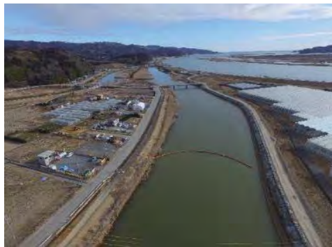
⑮ 311地震災第5020号 石巻市北上町橋浦 地内 皿貝川 河川堤防沈下
