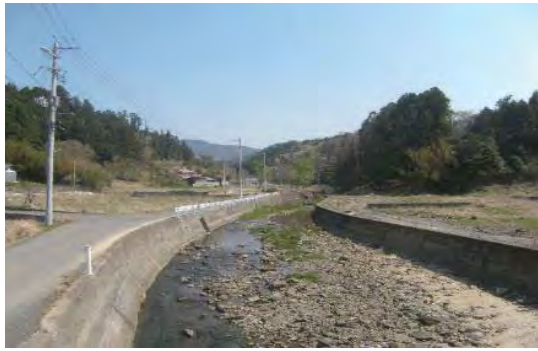
⑥ 淀川河川災害 石巻市十八浜地内 河川堤防沈下欠壊
