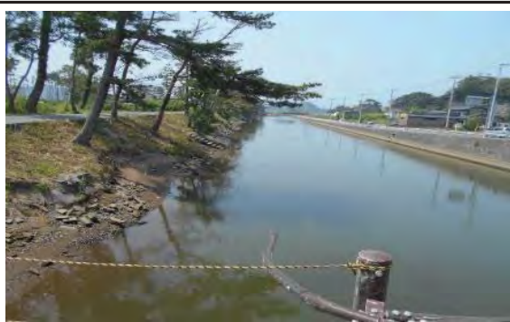
② 東名運河 東松島野蒜地内 河川堤防沈下欠壊
