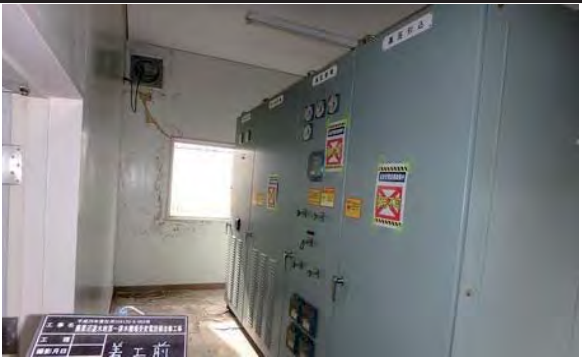
④ 大崎市田尻蕪栗字筒堀下地内 蕪栗沼遊水池第一排水機場受変電設備改修工事
