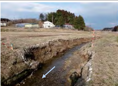
⑧ 瀬峰川 栗原市瀬峰小深沢地内 平成29年 河川災害復旧工事
