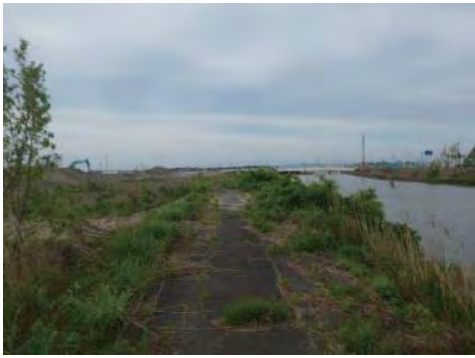
③一級河川名取川水系南貞山運河 岩沼市下野郷地内 河川災害復旧事業
