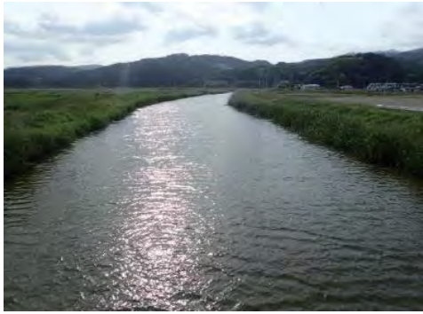
⑭ 311地震災第5020号 石巻市北上町十三浜地内 追波沢川 河川堤防沈下
