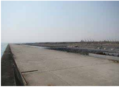
⑥ 仙台塩釜港石巻港区海岸雲雀野地区 石巻市雲雀野町地内 雲雀野地区防潮堤（その4）工事
