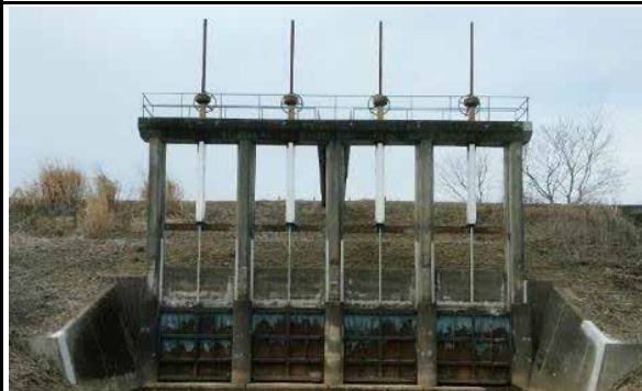
④ 栗原市若柳町南谷地 地内 南谷地流出樋門扉改良工事
