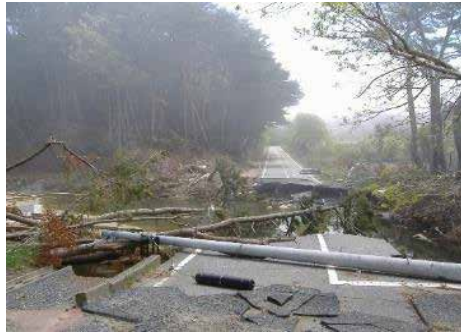
③ (一) 大島浪板線 気仙沼市小田の浜地内 災害復旧事業／道路災／小田の浜
