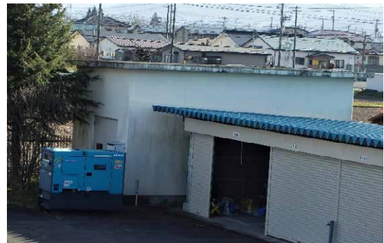
④ 大崎地方ダム総合事務所 令和2年4月14日 施工中（仮設非常用発電機設置）
