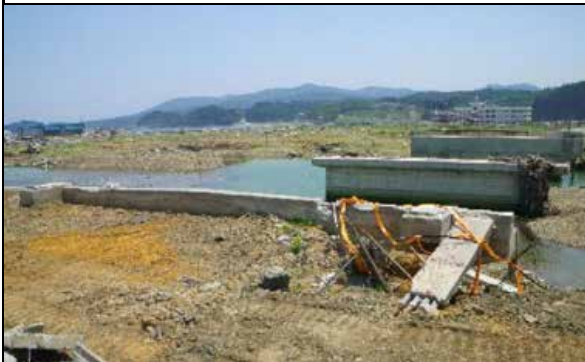
⑤ 国道398号 南三陸町戸倉字川向地内 折立橋災害復旧事業
