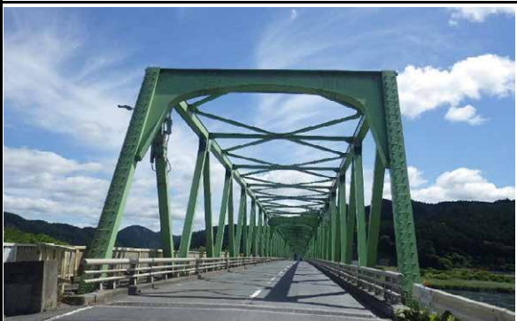
⑫ 登米市津山町柳津地内 (主) 涌谷津山線 柳津大橋橋梁耐震補強工事
