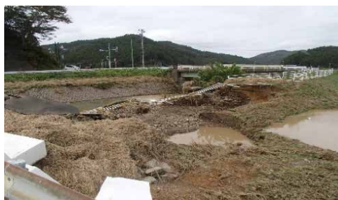
台風19号による石貝川の堤防決壊被害
