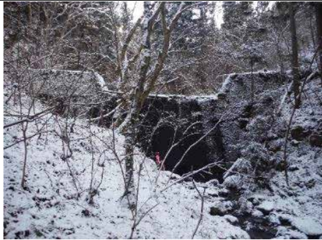
③ 登米市東和町錦織字畑ノ沢地内 鍋割堰堤改築工事
