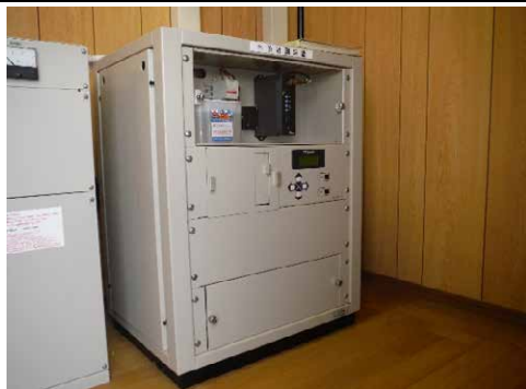
② 花山ダム 栗原市築館字留場遠の木 地内 留場水位観測所水位計修繕工事 着手前
