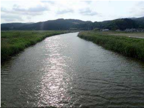
⑨ 311地震災第5020号 石巻市北上町十三浜地内 追波沢川 河川堤防沈下
