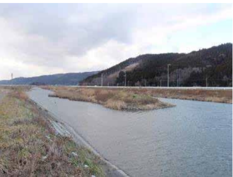
⑪ 311地震災第5020号 石巻市大網 地内 中島川 河川堤防沈下
