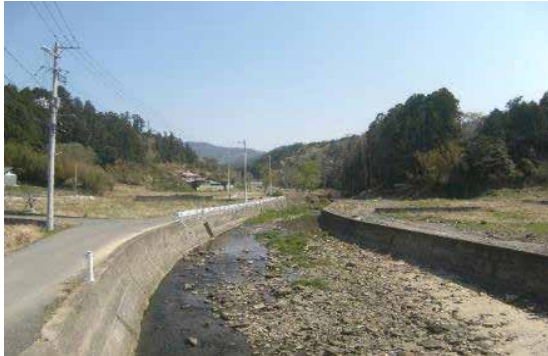
④ 淀川河川災害 石巻市十八浜地内 河川堤防沈下欠壊
