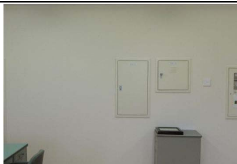
門沢除雪ステーション 加美郡加美町字漆沢嶽山 気象観測装置設置前
