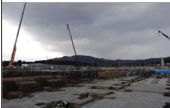
津波被災学校施設の移転・新築 （平成29年3月 現在 基礎 施工中）
