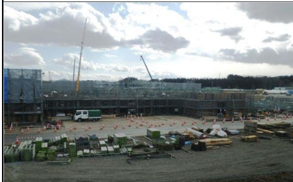
津波被災学校施設の移転・新築 平成29年2月 現在 躯体 施工中
