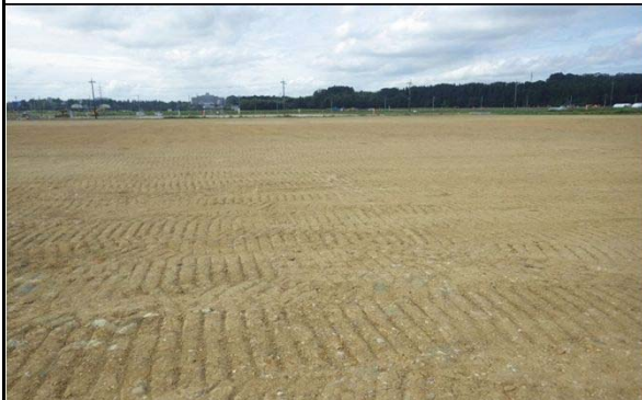
農業高校舎改築工事 名取市高館吉田字吉合地内（平成28年6月 着工）
