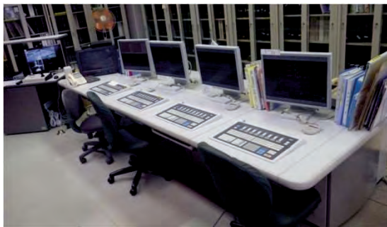
石巻浄化センター中央監視設備更新 施工前
