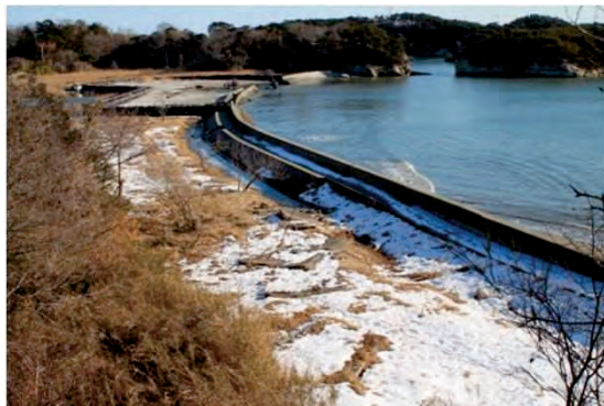
野々島海岸 塩竈市浦野々島地内 海岸堤防沈下欠壊
