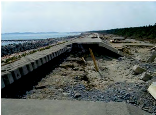
大曲地区海岸 東松島市大曲地内 海岸堤防欠壊
