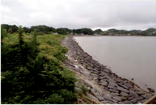
小白浜海岸 松島町手樽地内 海岸堤防沈下
