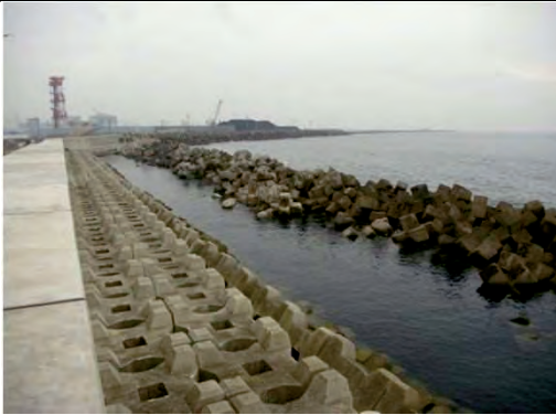
南防波護岸 仙台市宮城野区蒲生字町地内 被災状況（消波ブロックの流出・沈下）
