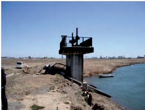
増田川 名取市関上地内 河川堤防沈下
