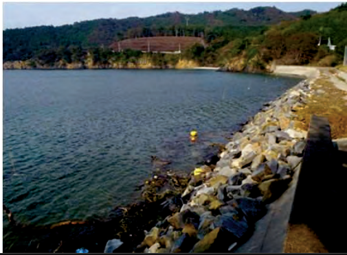
東侍浜地区海岸 石巻市荻浜地内 海岸護岸崩壊
