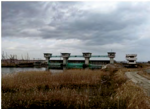
坂元川 山元町坂元地内 河川堤防沈下決壊
