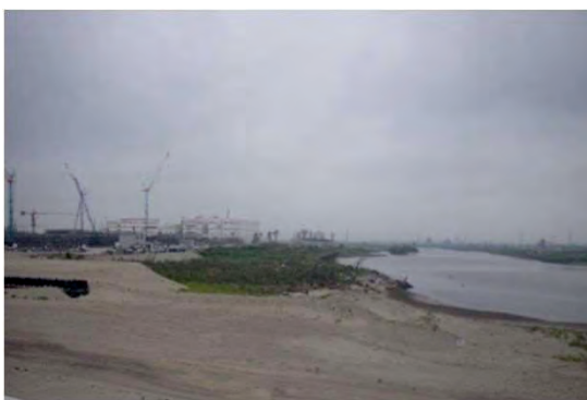
七北田川 仙台市宮城野区蒲生地内 河川堤防沈下
