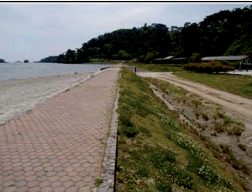
浪打浜(A)護岸 宮城郡松島町松島字霞ヶ浦地先 被災状況（沈下）
