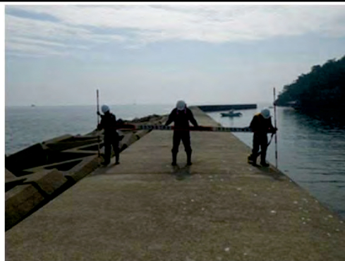
小浜（A）防波堤 七ヶ浜町花湊浜字館下地先 被災状況（防波堤の沈下）
