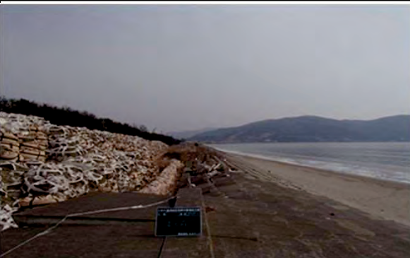
長浜地区海岸 石巻市渡波地内 海岸堤防（護岸）崩壊
