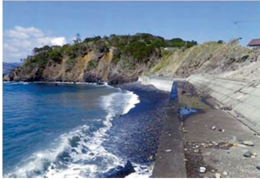
根組地先海岸 石巻市長渡浜地内 海岸堤防（護岸）沈下
