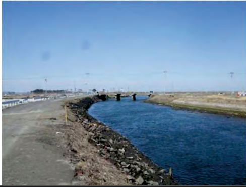
中貞山運河 名取市関上地内 河川堤防沈下
