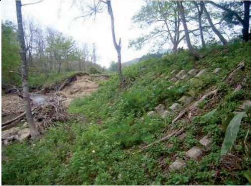
26災河川災害復旧事業 白石川 七ヶ宿町追分下地内 河川護岸欠壊
