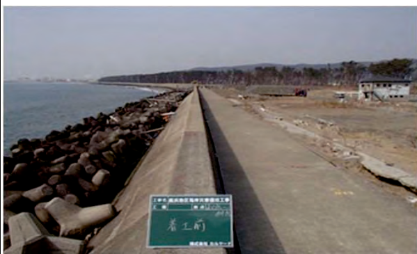
長浜地区海岸 石巻市渡波地内 海岸堤防（護岸）崩壊
