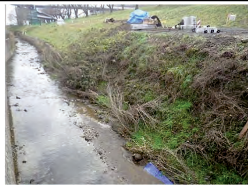
鷺沼排水路 柴田町大字船岡地内 法崩れ
