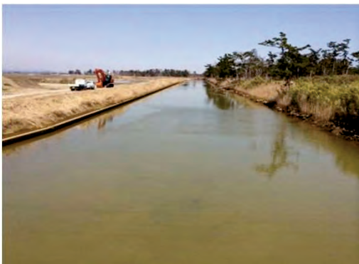
五間堀川 岩沼市寺島地内 河川堤防沈下
