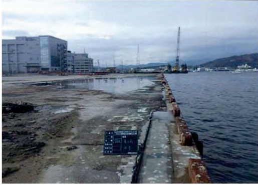
気仙沼港朝日地区岸壁 気仙沼市朝日町地内 地盤沈下
