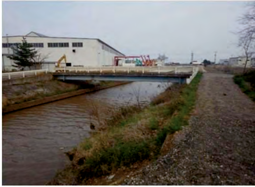
川内沢川 岩沼市下野郷地内 河川堤防沈下
