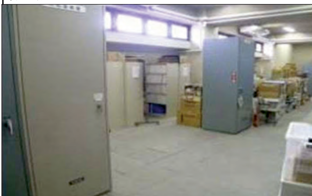
多賀城市大代地内 仙塩浄化センター汚泥処理施設監視制御設備長寿命化
