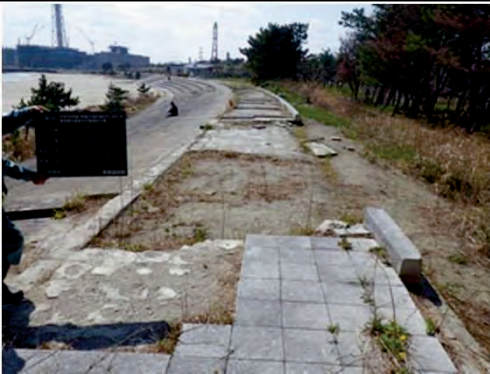
湊浜親水護岸 宮城郡七ヶ浜町湊浜地先 被災状況（流失及び沈下）
