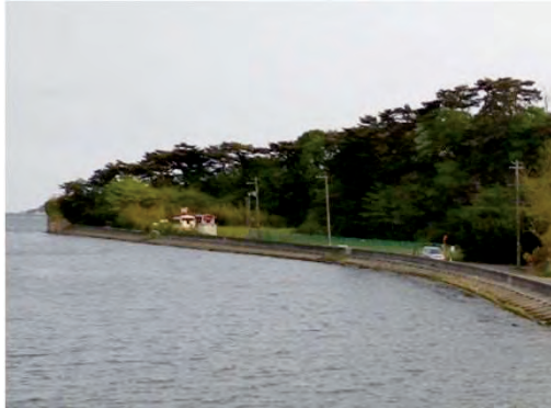
高城川 松島町高城地内 河川堤防沈下
