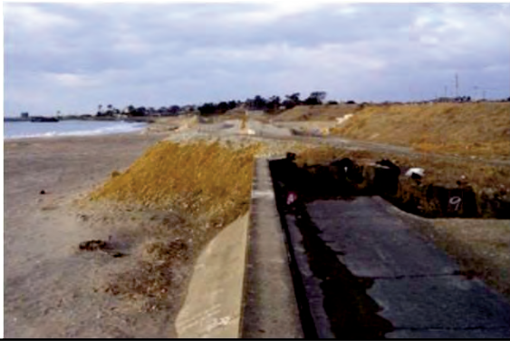
菖蒲田海岸 七ヶ浜町菖蒲田地内 海岸堤防沈下欠壊
