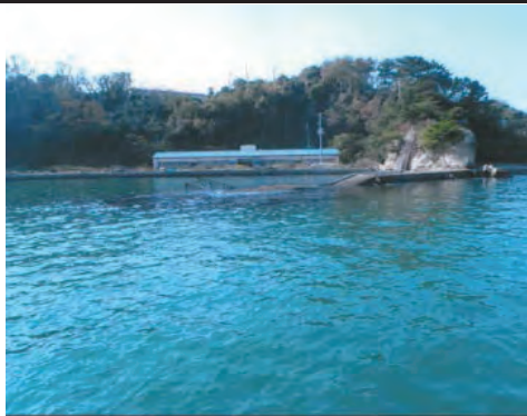
桂島スリス浜防波堤 塩竈市浦戸桂島地先外 被災状況（防波堤倒壊）
