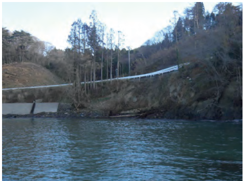
県道泊崎半島線 南三陸町歌津字館浜地内 道路法面崩落
