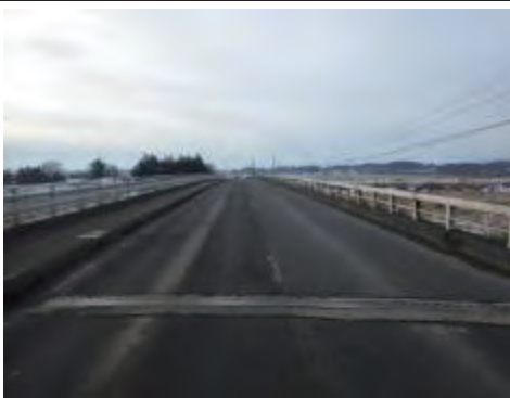
(主) 河南築館線 栗原市瀬峰下富川原地内 藤田橋橋梁耐震化工事
