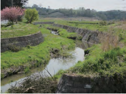
一級河川吉野川 大崎市岩出山下真山中谷内 河道掘削工事
