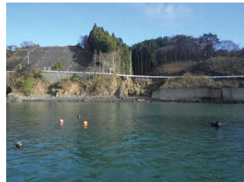
県道泊崎半島線 南三陸町歌津字館浜地内 道路法面崩落
