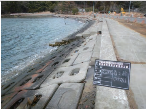
猪落地先海岸 女川町針浜字猪落地内 堤防沈下等
