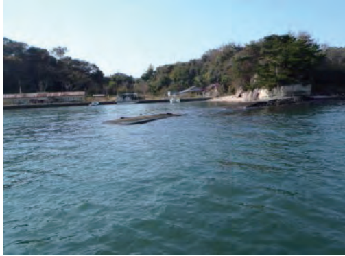
桂島梅ヶ浜防波堤 塩竈市浦戸桂島菖蒲地先外 被災状況（防波堤倒壊）
