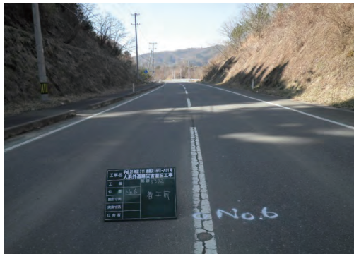
(国)398号 石巻市雄勝町大浜地内 道路舗装損傷
