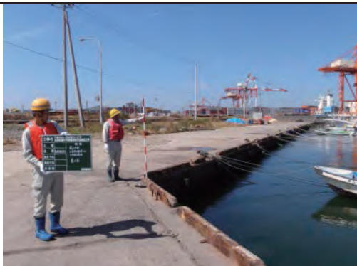
高砂船溜物揚場 仙台市宮城野区港一丁目地内 被災状況（物揚場沈下）
