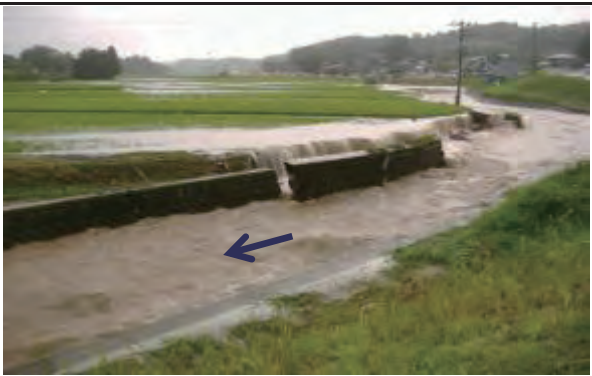
照越川 栗原市築館照越大ヶ原地内 平成25年7月豪雨による護岸被災状況
