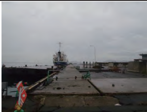
貞山ふ頭1号岸壁 塩竈市貞山通一丁目地内 被災状況（岸壁沈下）
