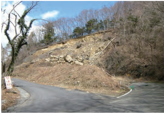
(一)釜谷大須雄勝線 石巻市雄勝町船越字荒地内 法面崩壊状況
