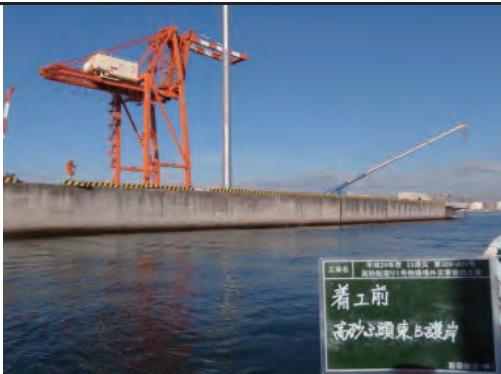
高砂ふ頭東B護岸 仙台市宮城野区港一丁目地内 被災状況（護岸はらみだし）
