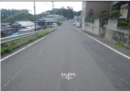
(一) 釜谷大須雄勝線 石巻市雄勝町大須地内 道路舗装損傷
