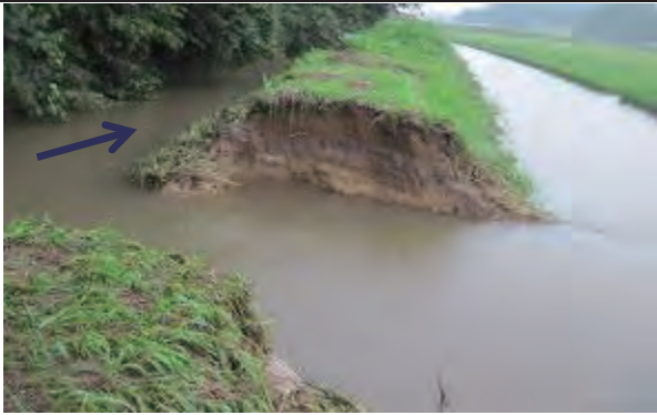
太田川 栗原市築館太田地内 平成25年7月豪雨による破堤状況
