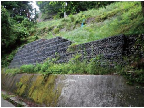
一般県道秋保温泉川崎線 川崎町小野地内 大平山災害防除工事 着工前
