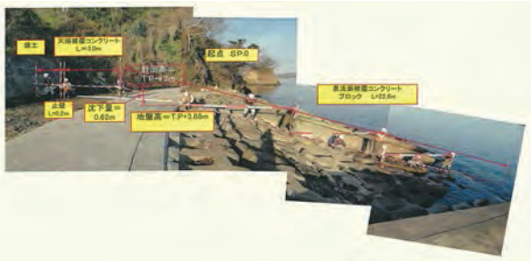
波伝谷地区海岸 南三陸町戸倉字合羽沢地内 海岸護岸沈下
