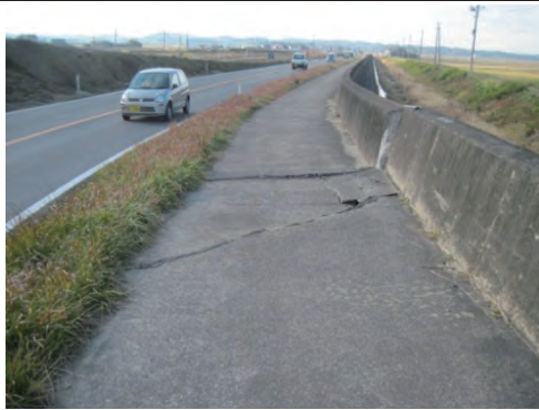
鶴田川（品井沼遊水地周囲堤） 大崎市鹿島台地内 遊水地周囲堤沈下・破損
