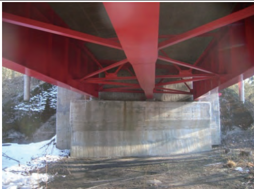
主要地方道白石上山線 蔵王町遠刈田温泉地内 清水原橋
