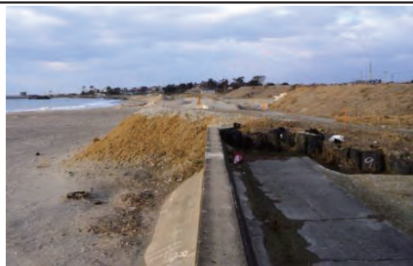
菖蒲田海岸 七ヶ浜町菖蒲田地内 海岸堤防沈下欠壊
