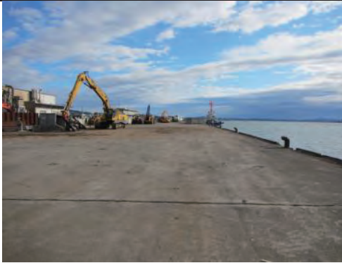
貞山ふ頭3・4号さん橋 塩竈市貞山通一丁目地内 被災状況（さん橋沈下）
