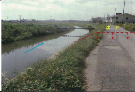
一級河川北上川水系金沢川 石巻市大瓜地内 堤防沈下等
