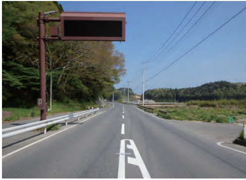
国道346号 気仙沼市本吉町岳の下地内 津波情報表示板損傷
