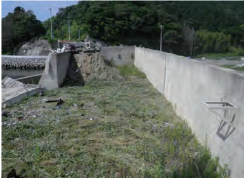
(国) 398号 石巻市相川地内 橋梁損傷状況
