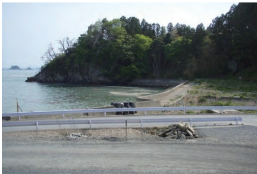
館浜地区海岸 南三陸町歌津字館浜地先 海岸護岸決壊
