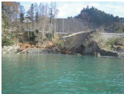
館浜道路の被災状況
