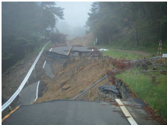
(一)牡鹿半島公園線 被災状況
