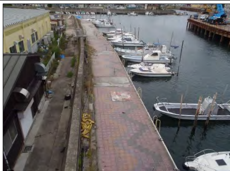
⑤ 仙台塩釜港塩釜港区 塩竈市中の島地先 中の島(B)胸壁沈下
