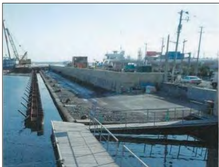
③ 仙台塩釜港塩釜港区 塩竈市海岸通地先 千賀の浦観光物揚場沈下
