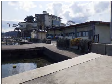
⑧ 仙台塩釜港松島港区 宮城郡松島町松島地先 東浜(B)胸壁沈下
