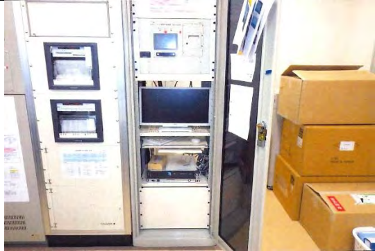
③ 上大沢ダム 大崎市鳴子温泉鬼首字上大沢川地内 化女沼ダム外堤体観測装置等修繕工事
