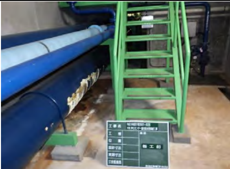
⑤ 黒川郡大和町鶴巢下草地内 大和浄化センター場内排水管修繕工事
