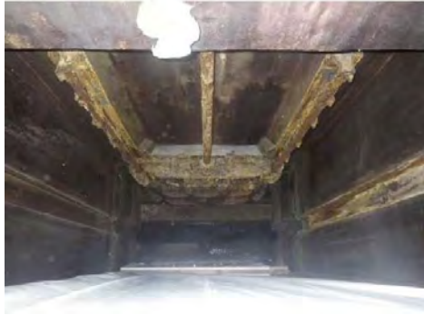
③ 多賀城市大代地内 仙塩浄化センター沈砂池機械設備長寿命化工事
