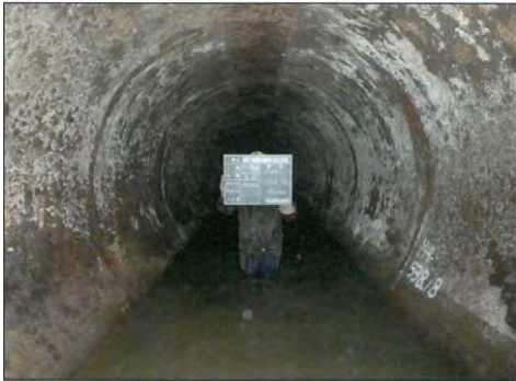
① 阿武隈川幹線 岩沼市吹上地内 管路腐食
