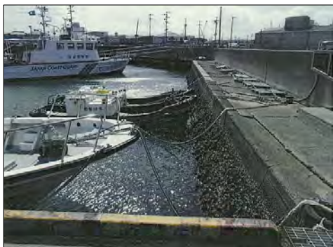
④ 仙台塩釜港塩釜港区 塩竈市港町一丁目地先 西ふ頭物揚場及び胸壁沈下
