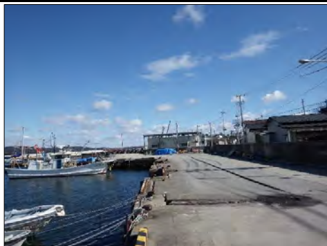
⑦ 仙台塩釜港塩釜港区 宮城郡七ヶ浜町代ヶ崎浜清水地先 防潮堤及び物揚場沈下
