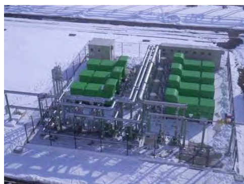
平成30年1月25日 発電施設設置状況
