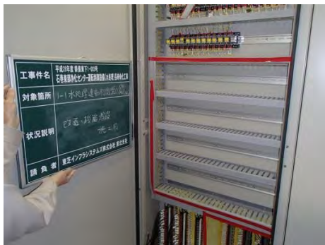
③石巻東部浄化センター 石巻市魚町一丁目地内 運転制御（水処理）長寿命化工事着手前
