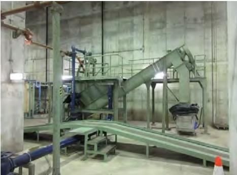
④ 亶理郡亶理町荒浜地内 亶理ポンプ場機械設備改築工事
