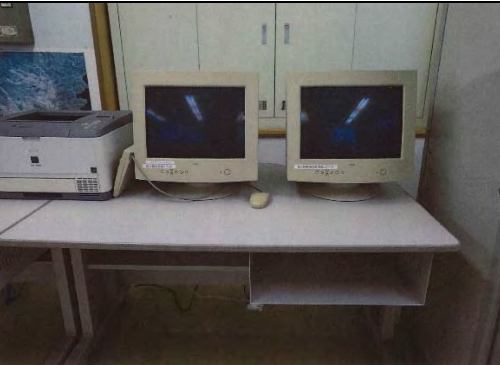
① 漆沢ダム管理事務所 加美郡加美町字宮ヶ森地内 漆沢ダム管理用制御処理設備改良1期工事
