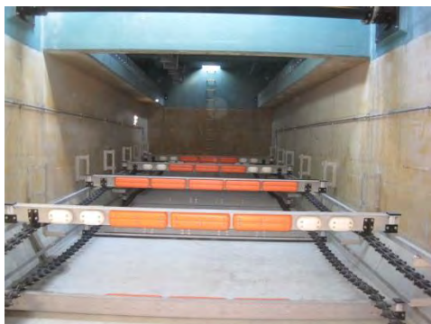
写真2. 最初沈殿池掻寄機
