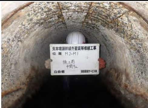
⑤女川幹線管渠 石巻市流留七勺地内 管渠更生工事着手前
