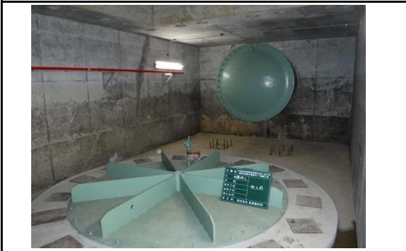
② 登米市迫町北方字仮屋地内 迫川(荒川)河川改修 仮屋河道排水機場 ポンプ増設
