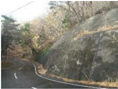
⑱ 大石原浜地区 牡鹿郡女川町大石原浜地内 道路法面对策
