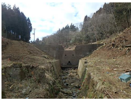
⑪ 北上川圏域 気仙沼市本吉町西川内地内 尾持沢砂防堰堤の緊急改築
