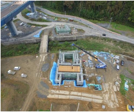
⑥ 平成27年12月5日 橋梁下部工施工状況 宮城県本吉郡南三陸町歌津字白山地内
