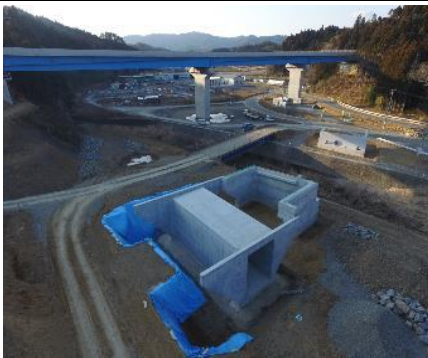
⑧ 平成29年3月24日 橋梁下部工施工状況 宮城県本吉郡南三陸町歌津字白山地内
