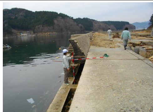
⑧日向貝地先海岸 気仙沼市唐桑町西舞根地内 海岸堤防沈下欠壊
