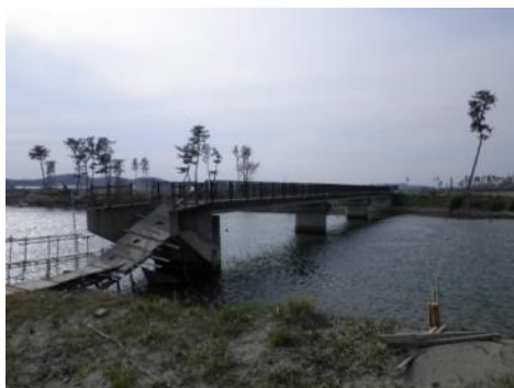
⑧ (一) 石巻松島自転車道線 東松島市浜市地内 浜市橋橋梁災害復旧工事
