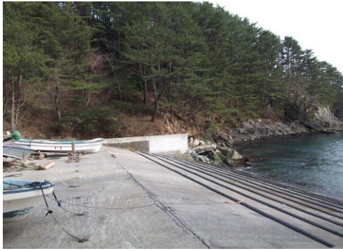
⑥高石浜地区海岸 気仙沼市唐桑町高石浜地内 海岸堤防沈下欠壊
