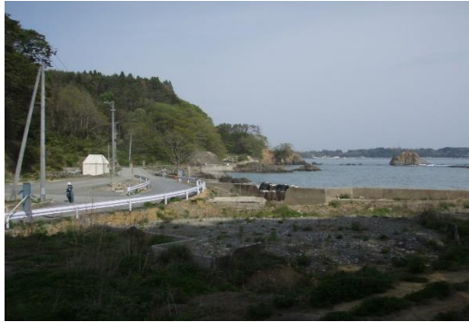
⑩ 館浜地区海岸 南三陸町歌津字館浜地内 海岸堤防沈下欠壊
