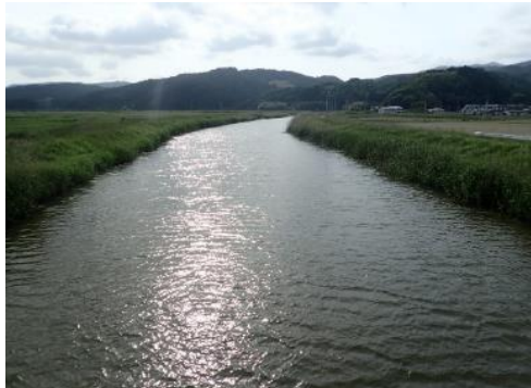
⑫311地震災第5020号 石巻市北上町十三浜地内 追波沢川 河川堤防沈下
