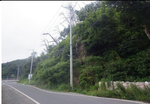
⑬ 道路災害防除 気仙沼市小々汐地内 落石
