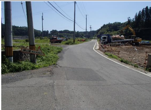
⑭道路災害復旧 南三陸町歌津字田ノ浦地内 路面欠損
