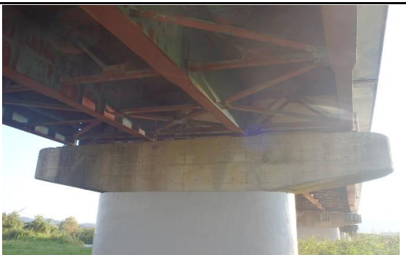
⑦ 登米市豊里町一番江地内 二ツ屋橋外橋梁耐震補強工事(二ツ屋橋)
