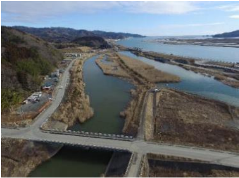
⑮ 311地震災第5020号 石巻市北上町十三浜 地内 大沢川 河川堤防沈下
