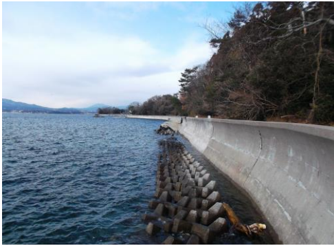
⑨ 中沢地先海岸 気仙沼市駒形地内 海岸堤防沈下欠壊
