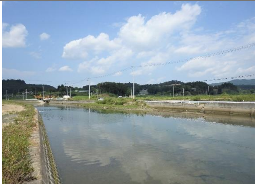
⑤水尻川 南三陸町志津川字大久保地内 河川堤防沈下欠壊
