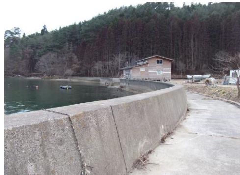
⑦西舞根貝浜地先海岸 気仙沼市唐桑町西舞根地内 海岸堤防沈下欠壊
