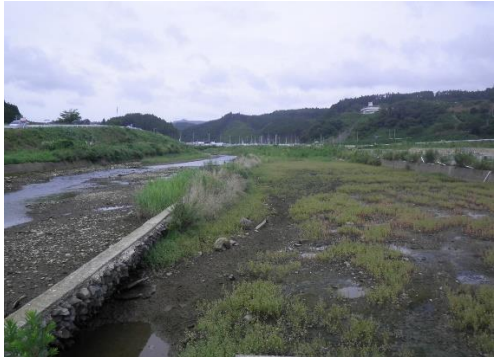
④八幡川 南三陸町志津川字塩入地内 河川堤防沈下欠壊
