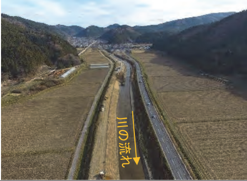
③南沢川 登米市津山町横山字南沢地内 南沢川改修工事（下流側より）令和3年1月
