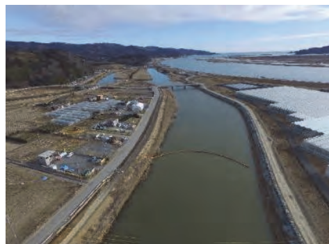
⑩311地震災第5020号 石巻市北上町橋浦 地内 皿貝川 河川堤防沈下
