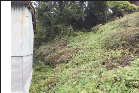
① 素山急傾斜地崩壊危険区域 素山県単急傾斜地崩壊対策工事
