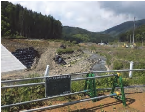
⑨ 雄勝復興道路 石巻市雄勝町雄勝地内 雄勝3号橋着工前
