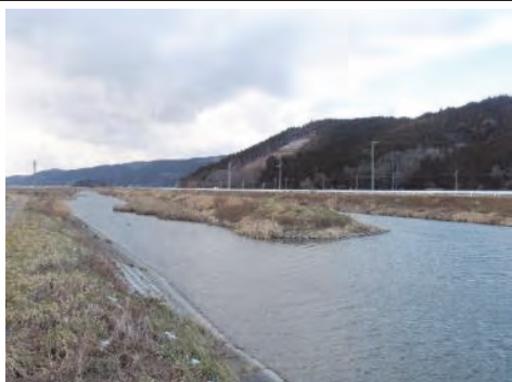
⑪ 311地震災第5020号 石巻市大網 地内 中島川 河川堤防沈下
