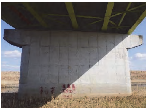
⑦ 登米市迫町北方字飯土井地内 （国）398号 飯土井大橋橋梁耐震補強工事
