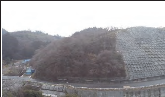
⑧ 登米市東和町錦織字馬口窪地内 （一）東和薄衣線 丸森災害防除工事
