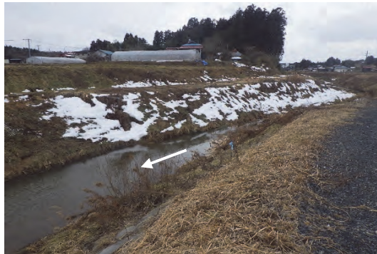
④ 照越川 栗原市築館字照越堀ノ内地内 照越川河川改修
