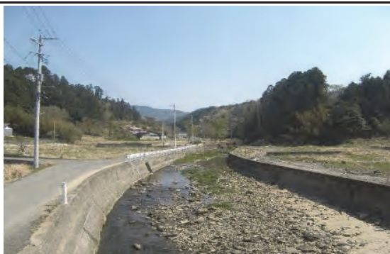
④ 淀川河川災害 石巻市十八浜地内 河川堤防沈下欠壊
