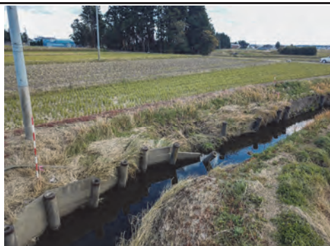
⑤ 一級河川鳴瀬川水系名蓋川 加美郡加美町菜切谷地内 渋井川外河川災害復旧工事（その2）
