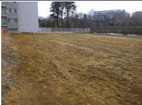
⑧令和3年2月15日 着工 角五郎単身用待機宿舎新築工事 仙台市
