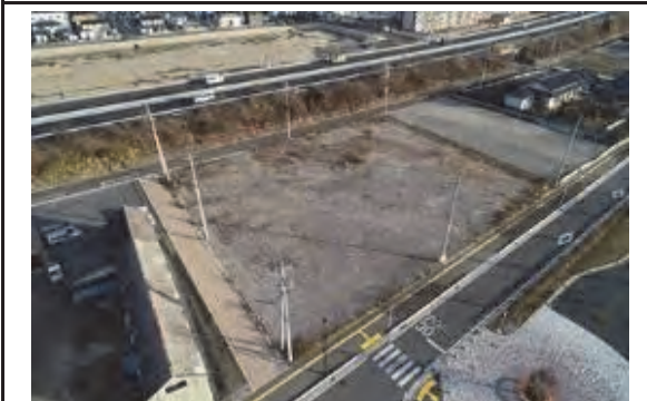
⑤令和元年11月28日 着工 石巻警察署新蛇田南待機宿舎新築工事 石巻市
