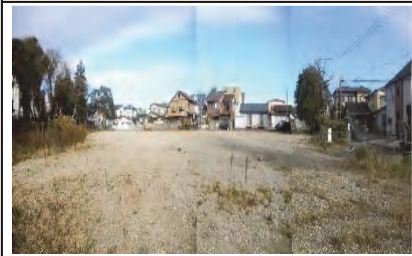
④令和元年11月14日 着工 石巻警察署南光町待機宿舎新築工事 石巻市
