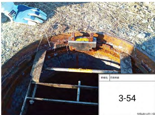
マンホール腐食状況
