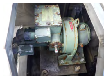
1系終沈掻寄機駆動部
