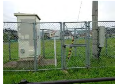
石巻第1ポンプ場操作盤他
