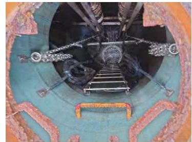
石巻第1ポンプ場内部
