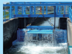
小水力発電施設
