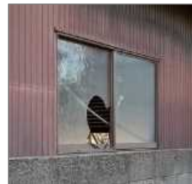
窓が割れた管理不全空家
