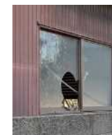
窓が割れた管理不全空家
