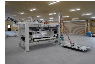
▲廃太陽光パネルの処理設備
