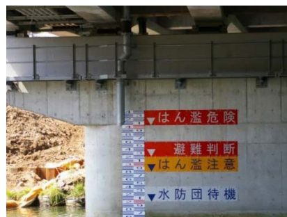
橋脚への水位表示例
