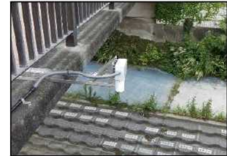
水位計の整備、改良
