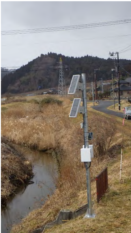
監視カメラ 設置状況（新川）
