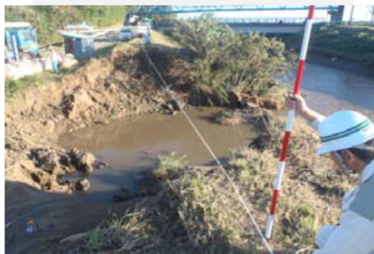
砂押川の破堤状況
