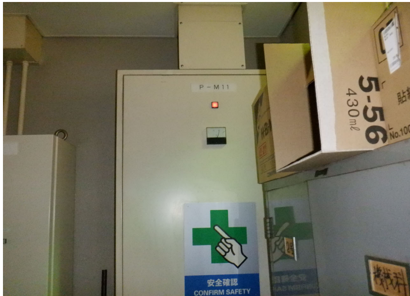
不良ブレーカー設置盤P-M11
