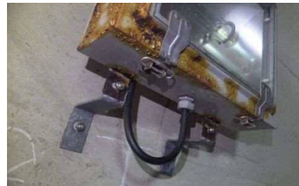
図4-4 健全度Ⅲの損傷例(附属物)
