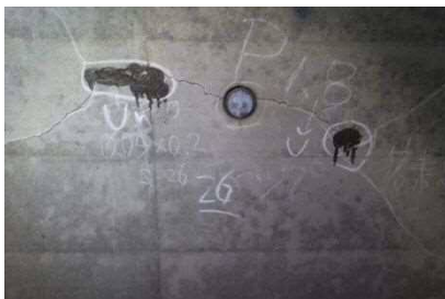
図4-3 健全度Ⅲの損傷例(トンネル本体)
