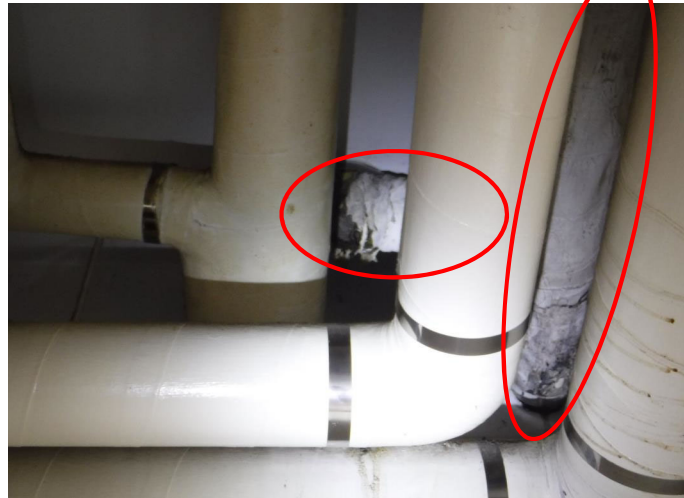
配管からの漏水による保温部の腐食状況
