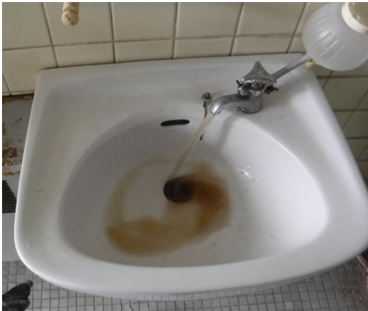
洗面器より赤水(配管内部に錆, 腐食)を確認
