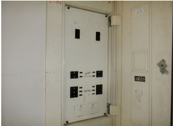
3階L-A3分電盤
